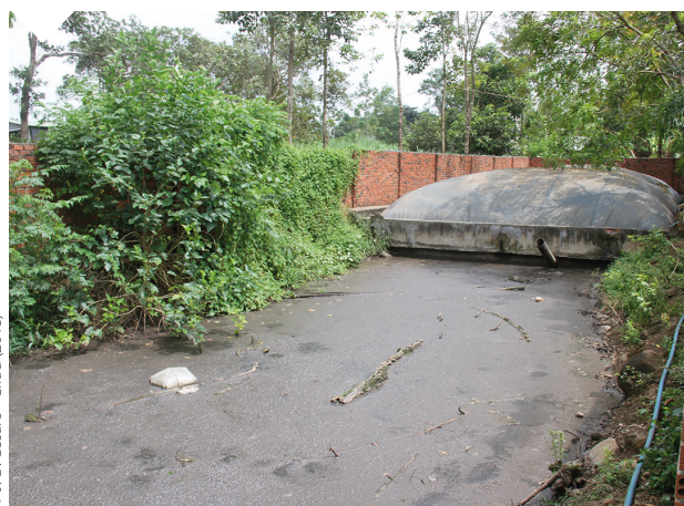
Des systèmes de biogaz sous dimensionnés
