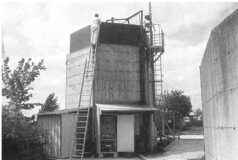
Photo 8 : Procédé intensif d'élimination de l'azote et de désodorisation (conception CEMAGREF) (photo CEMAGREF, J. Coillard)
