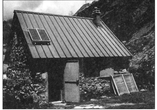
Photo 2. Des panneaux photovoltaïques, fixés sur le toit, peuvent fournir l'électricité des alpages qui n'ont pas de ressource en eau exploitable, mais à puissance égale, c'est une solution plus onéreuse que l'hydroélectricité.
