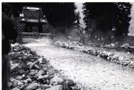
Broyeur de pierres
