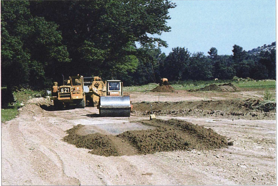
▲ 3 - Planche d'essai d'un très petit barrage (au fond le compacteur à rouleau lisse et une décapeuse qui amène la terre depuis la zone d'emprunt (texte p. 103).
