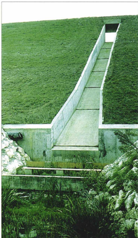
◀ 19 - Déversoir à entonnement frontal, coursier posé sur remblai et dissipateur d'énergie (texte p.96).
