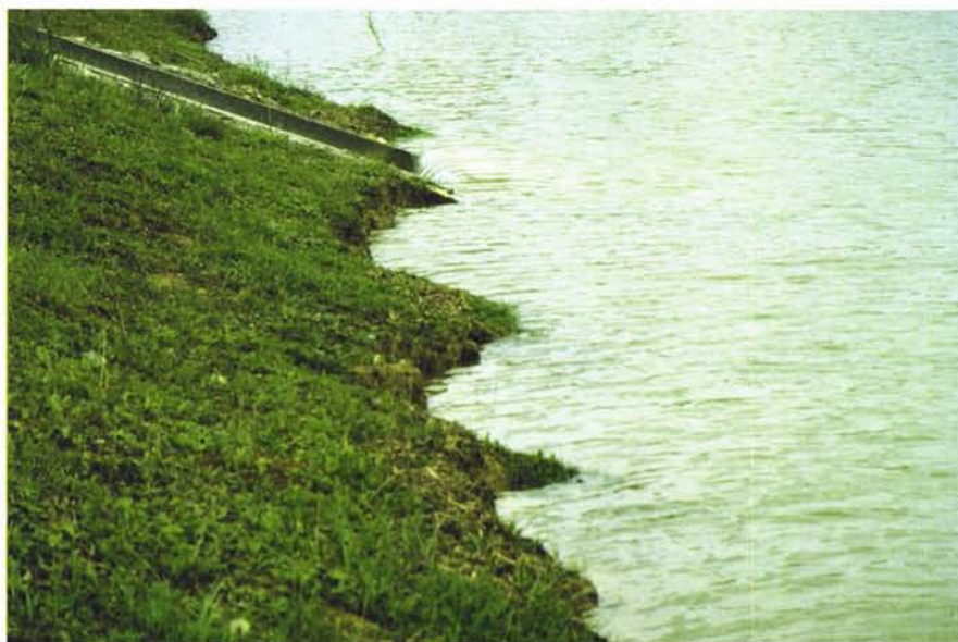
Photographie 7 – Talus enherbé marqué par le batillage au niveau de la retenue normale (marche de 0,3 à 0,5 m).
