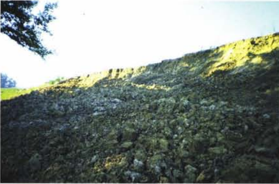
Photographie 42 – Petit barrage hors enquête caractérisé par une pente de talus de 1/1, l'absence de drain et un compactage négligé. On voit ici l'écroulement du talus aval saturé.
