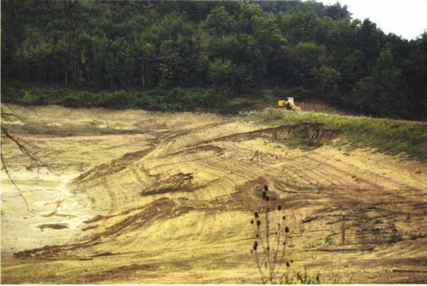
Photographie 37 – Barrage d'ARMOUS et CAU (Gers). Le glissement du talus amont. Vue de la rive droite.
