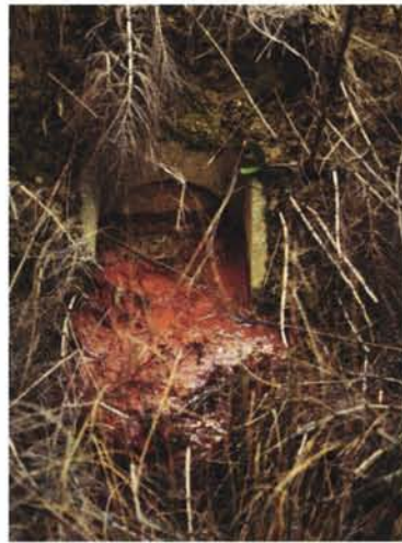
Photographie 25 – Boues ferriques obstruant la sortie d'un exutoire du drain.
