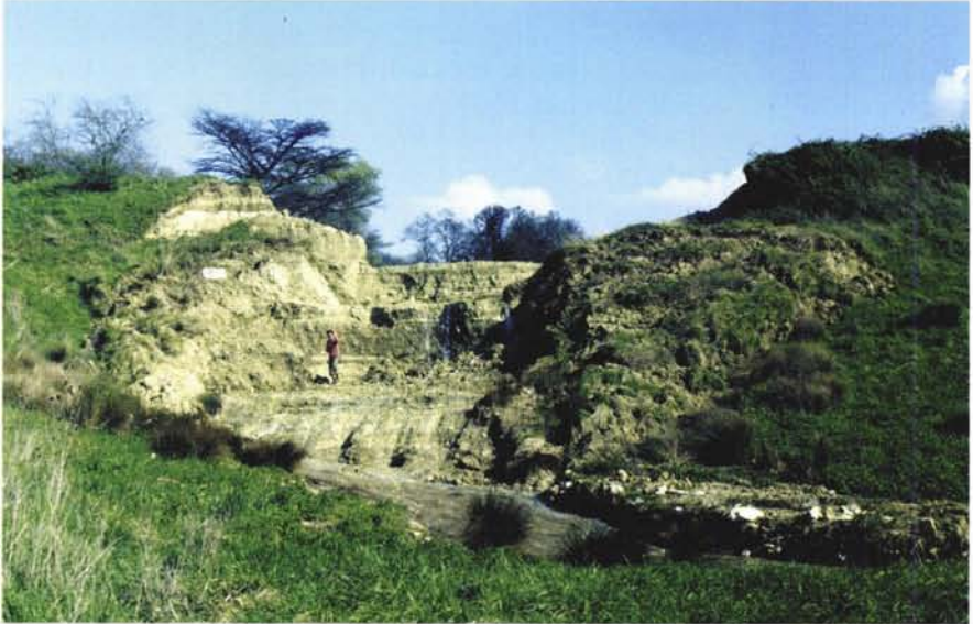
Photographie 41 – Barrage de SAINT AIGNAN (Gers). Rupture provoquée par « l'explosion » de la partie supérieure du remblai au débouché d'un renard sur le talus amont. La largeur de la brèche tient au feuilletage du remblai construit avec des matériaux médiocres.
