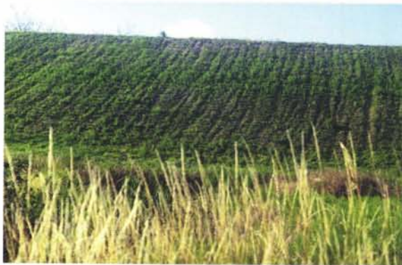
Photographie 6 – Le ravinement du talus aval d'un barrage de Haute-Garonne (profondeur des ravines env. 0,3 m).
