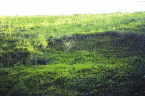
Photographie 43 – Petit barrage hors enquête ayant une pente de talus de 1/2 et un drainage sommaire. Loupe de glissement dans les terrains saturés de la base du remblai.
