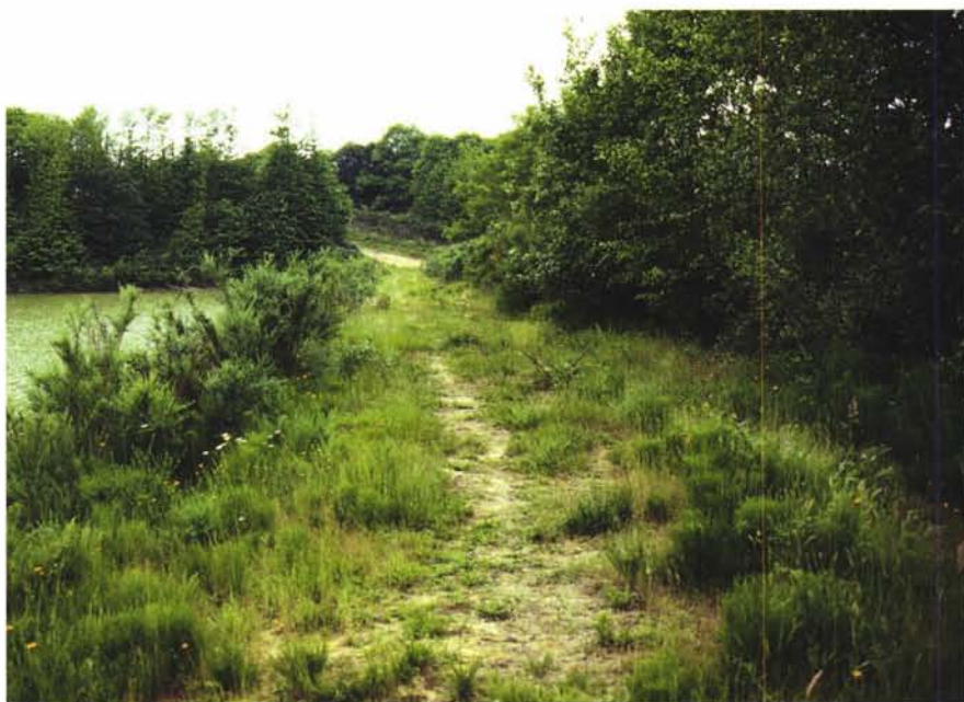
Photographie 16 – Entretien très négligé du remblai. Le talus aval n'est plus accessible.
