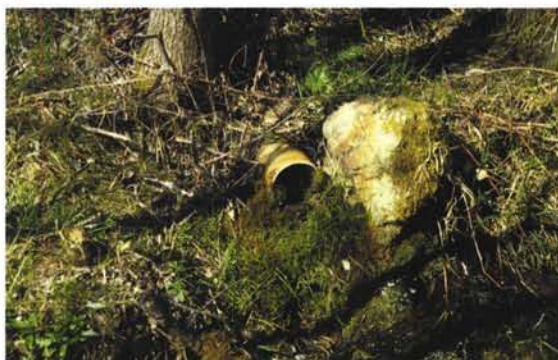
Photographie 26 – Sortie de drain pincée par les racines d'un arbre (il ne coule plus).
