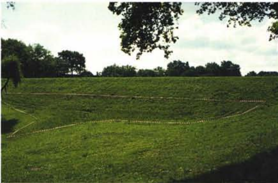
Photographie 44 – Petit barrage hors enquête caractérisé par une pente de talus de 1/2 et l'absence de drain. Balisage de la zone de résurgence de la nappe phréatique sur le talus aval.
