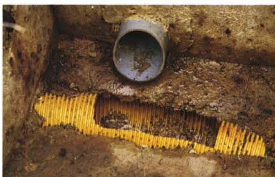
Photographie 27 – L'intérieur d'un regard montrant une sortie de drain en Ø 65 mm et le collecteur de pied en Ø 120 mm à la base du regard. On notera ici la difficulté de jaugeage du débit de drainage (sortie de PVC trop basse).
