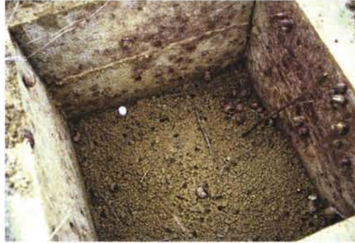
Photographie 24 – Regard en partie colmaté par la sédimentation des limons apportés par les eaux de ruissellement lors d'une pluie d'orage. L'exutoire du drain est noyé par les limons.
