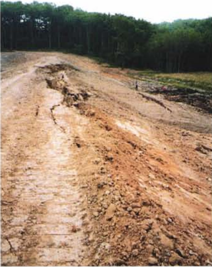
Photographie 39 – Barrage de BEDOREDE D'YNIIS (Landes). Le glissement du talus aval.
