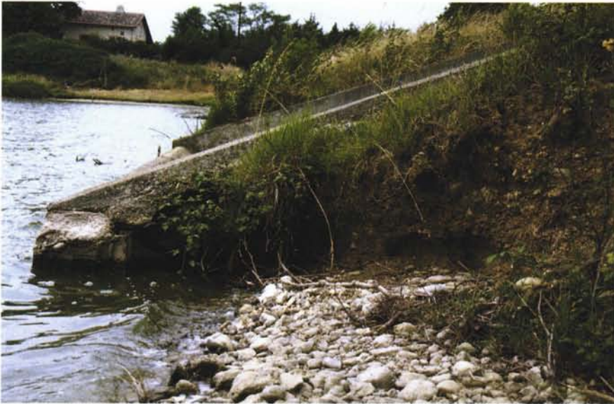
Photographie 10 – Le talus amont du barrage de LAUNAC (Haute-Garonne). On voit ici les effets du battillage au voisinage du déversoir en 1998 (le talus a été conforté après la tempête de décembre 1999).
