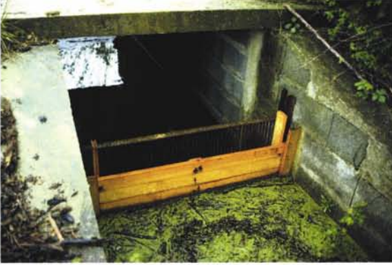
Photographie 34 – Un exemple de rehausse amovible à l'entrée d'un déversoir de type mixte.
