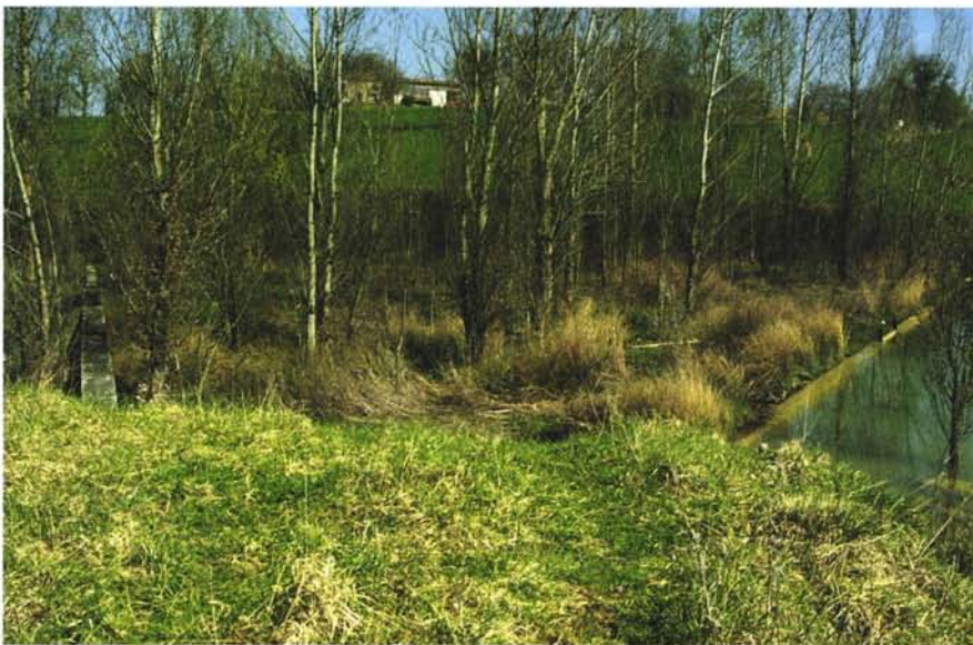
Photographie 19 – Evacuateur de type composite qui n'a jamais été entretenu. Les arbres et la végétation herbacée ont envahi le « sas » (voir figure 11 (d)) qui se comble peu à peu.
