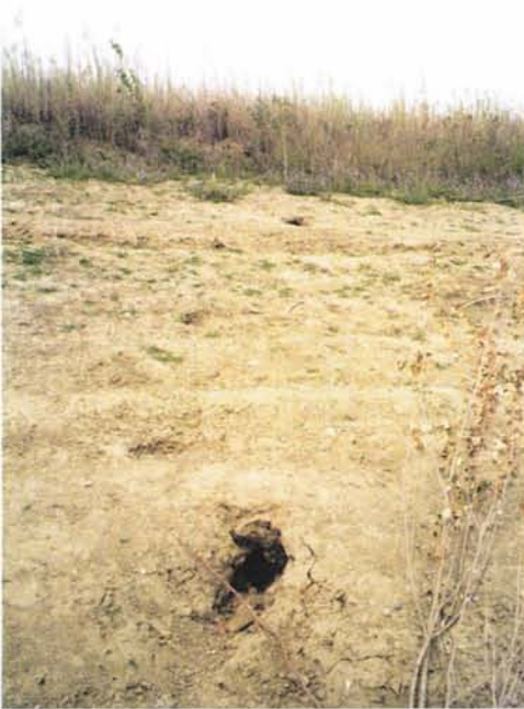
Photographie 50 – Barrage de AZAS (Haute-Garonne). Dégradation du remblai en terre par des terriers de ragondin. On notera la présence d'une galerie au-dessous de chaque niveau de marnage.
