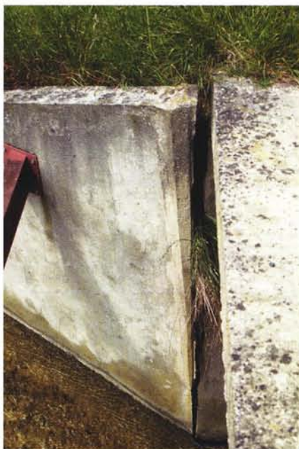
Photographie 30 – Ouverture importante de joint à l'entrée du chenal d'un évacuateur en béton.
