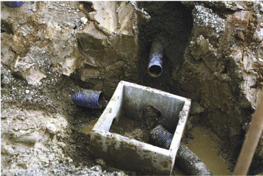
Photographie 40 – Barrage de BEDOREDE D'YNIIS (Landes). Détail montrant le déplacement d'un regard ainsi que la torsion d'un exutoire du drain interne et du collecteur au pied aval, après l'accident.
