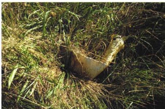
Photographie 21 – Exutoire de drain écrasé.
