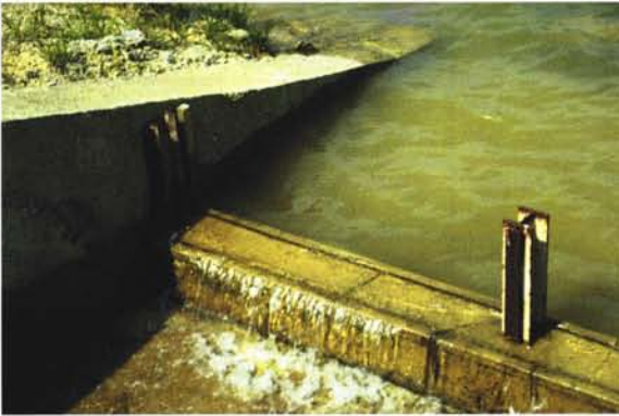
Photographie 35 – Rehausse du seuil déversant par une poutre en béton. Remarquer les fers en H fixés aux bajoyers et destinés à la mise en place d'une rehausse amovible supplémentaire.
