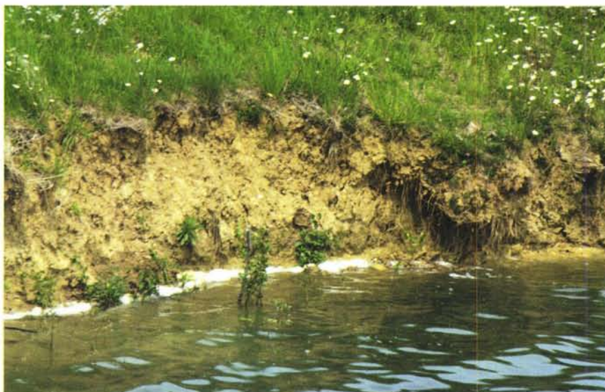
Photographie 8 – Un exemple de forte dégradation du talus amont par les vagues (marche supérieure à 0,8 m à la cote normale du plan d'eau).
