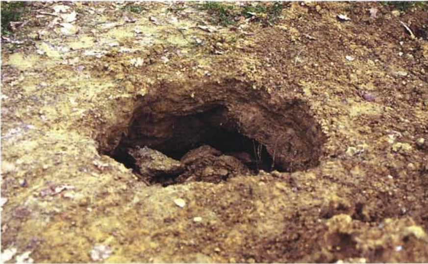
Photographie 51 – Barrage d'AURENSAN (Gers). Fontis de 0,8 m de diamètre en crête d'ouvrage.
