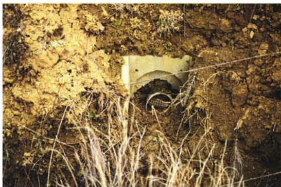
Photographie 20 – Sortie de drain renforcée par un 1/2 regard en partie obstruée par des éboulements de terre.
