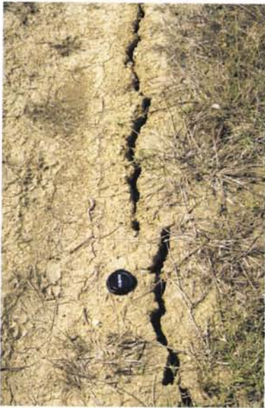
Photographie 5 – Un exemple de fissure structurale.
