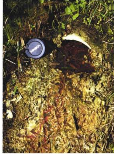
Photographie 23 – Exutoire de drain presque totalement bouché par des dépôts minéraux (dépôt de calcite).
