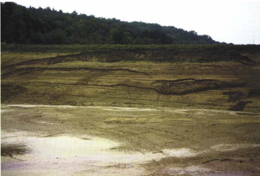
Photographie 38 – Barrage d'ARMOUS et CAU (Gers). Vue de face du glissement.
