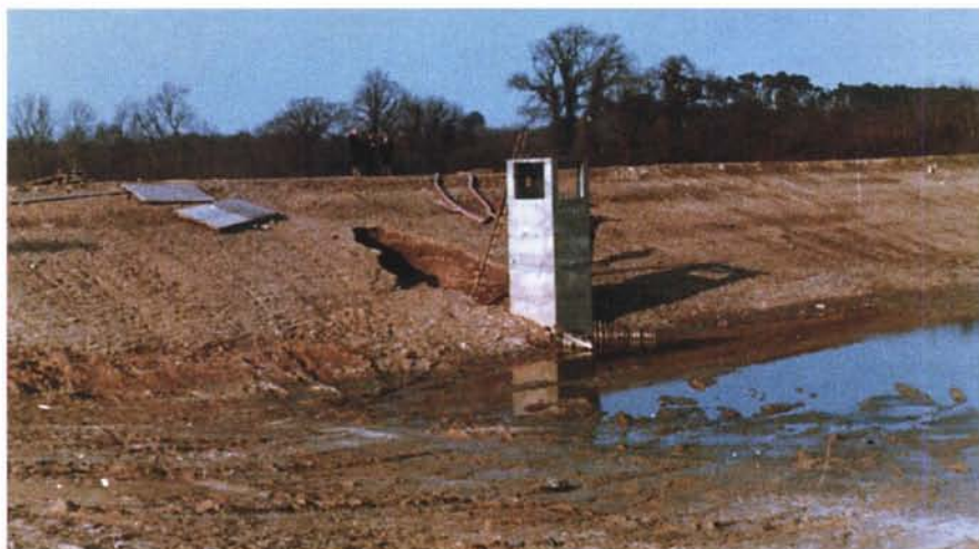
Photographie 46 – Barrage de SAINT JULIEN DES LANDES (Vendée). Vue générale après la rupture.
