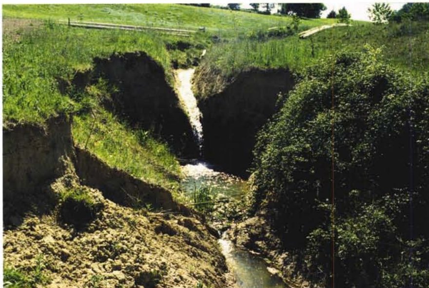
Photographie 32 – Un exemple classique d'érosion d'un coursier en terre.
