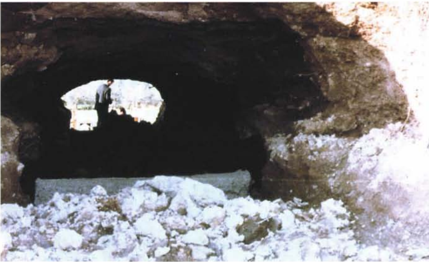
Photographie 47 – Barrage de SAINT JULIEN DES LANDES (Vendée). Le renard vu de l'amont après l'extraction de la conduite de vidange.
