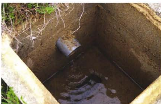
Photographie 28 – L'intérieur d'un regard. La sortie du drain est fonctionnelle mais le collecteur de pied en Ø 120 mm est en partie obstrué par un bouchon de terre ou un pincement du conduit sur son trajet. L'eau de drainage ne s'écoule plus correctement vers l'aval.
