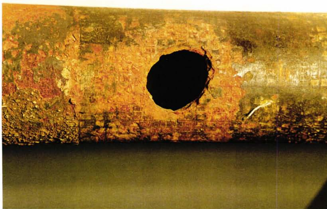
Figure A5 : Photographie d'une conduite de diamètre 80 mm ayant subi une corrosion externe localisée (courants vagabonds, hétérogénéité de sol, ...).
