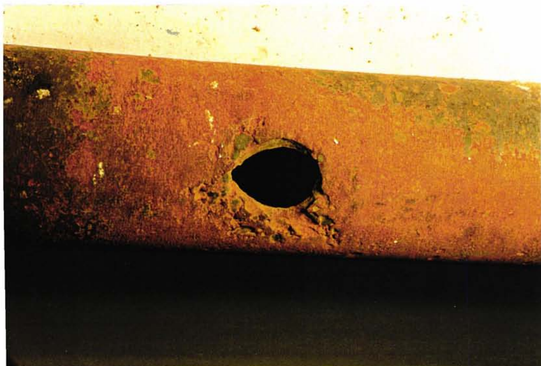
Figure A6 : Même conduite que la photographie précédente.
