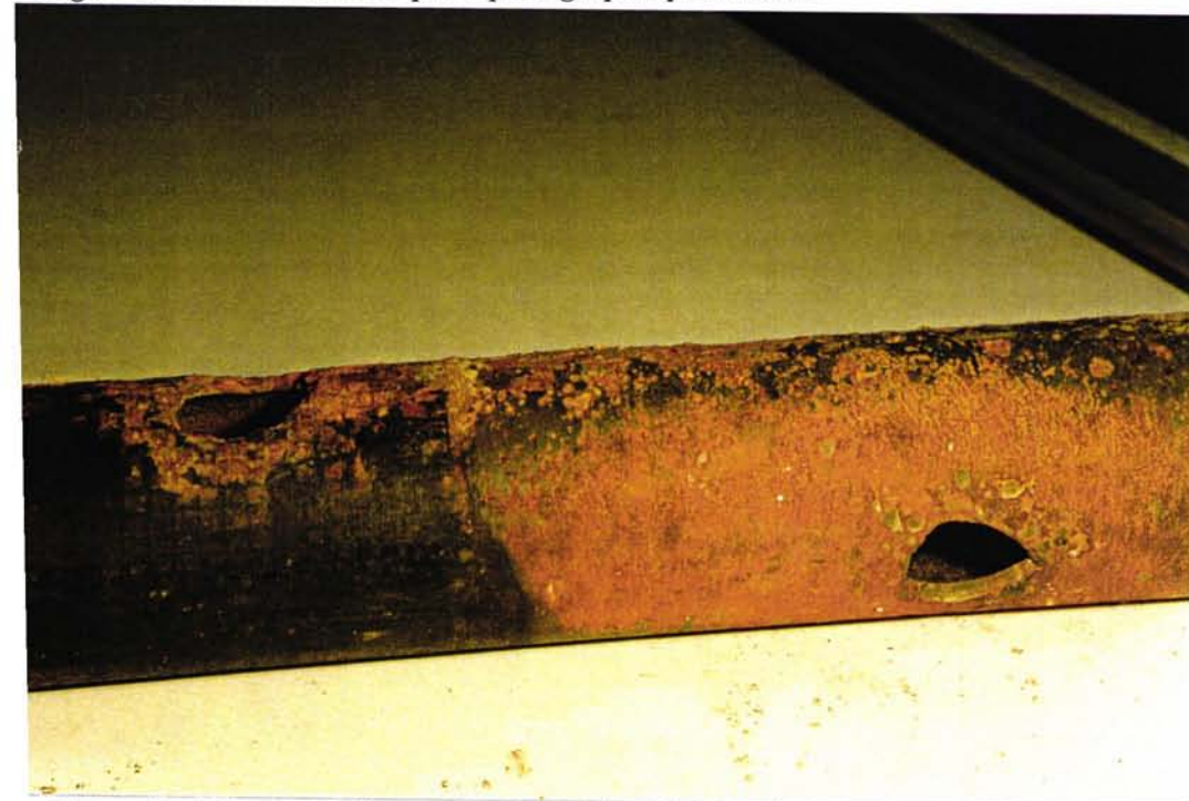
Figure a7 : Même conduite avec les deux points de corrosion.
