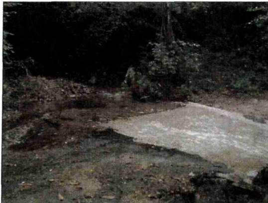
Dépôt de matériaux et colmatage des buses en arrière du gué sur le Cartaou
