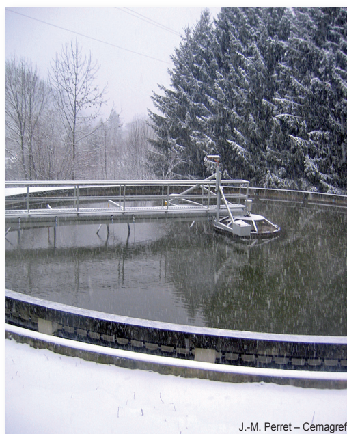
► Photo 2 – Station d'épuration de montagne (clarificateur).
