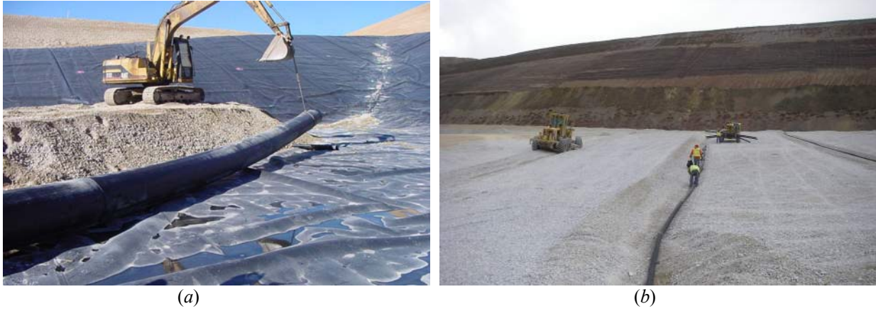
Figure 8. Installation de tubes rigides en PE : (a) sans tranchée et (b) installation dans une tranchée
