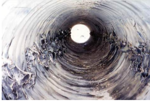
Figure 13. Rupture de géodrain
