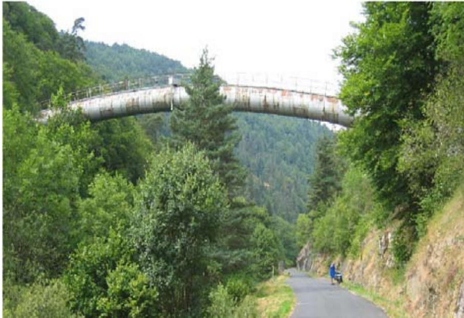
Conduite forcée sur le bassin de l'Allier. Photo G. Bouleau.
