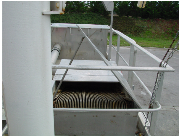
Photo : dégrilleur automatique
