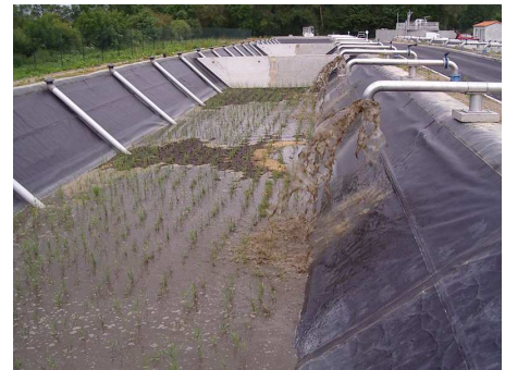
Déshydratation naturelle par lits plantés de roseaux (Source : CG Vendée)
