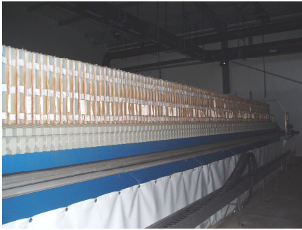
Filter presse (Photographie STEP de Limoges)
