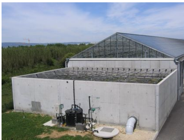
Photo 4 : Désodorisation biologique sur le site de Saint Paul 3 Châteaux (26)
