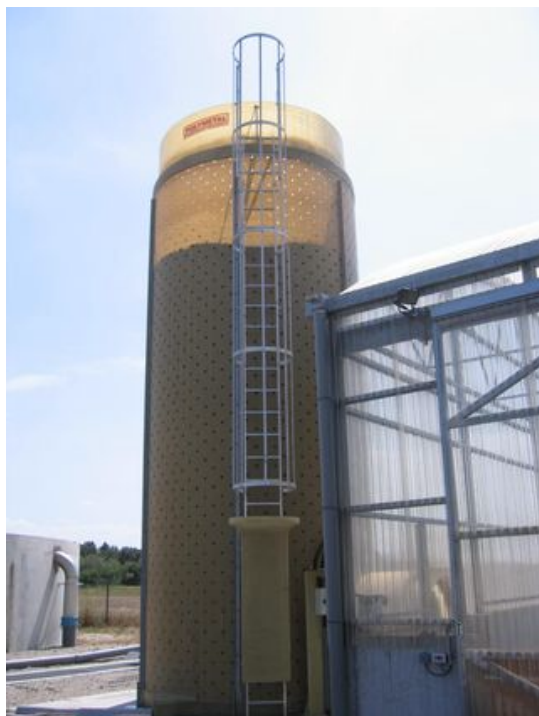
Photo 3 : Désodorisation biologique sur le site de Peyruis (04)
