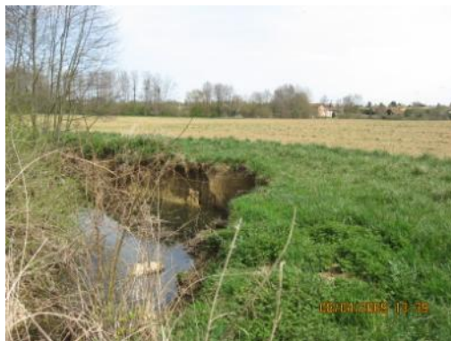
Rétrécissement de la bande enherbée, suite à une érosion locale de la berge
