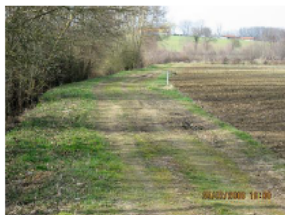
Tassement et dégradation
