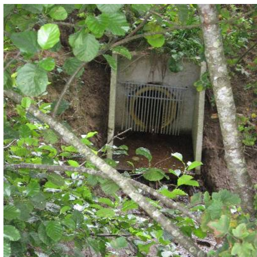
J.J. Gril Cemagref Sortie de collecteur de drainage
