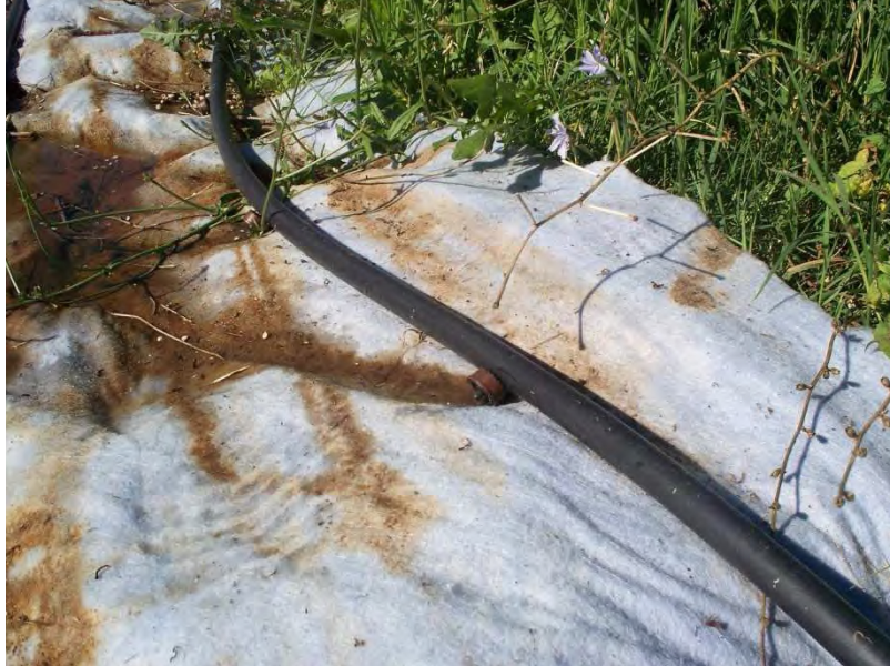
Prolifération au niveau des goutteurs montés en dérivation.
