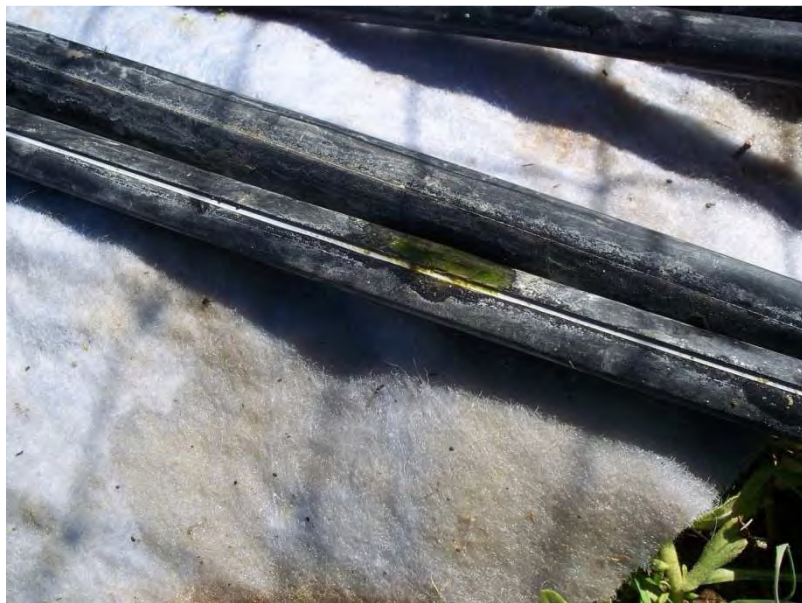
Prolifération au niveau des gaines.
