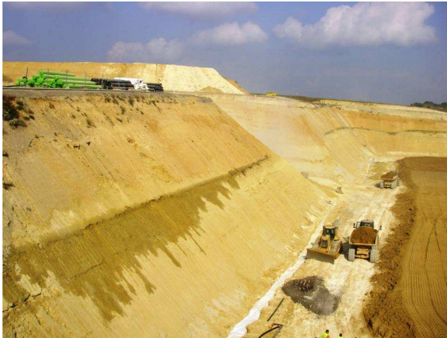
Figure 7 – Illustration d'arrivées d'eau latérales sur talus intérieur
