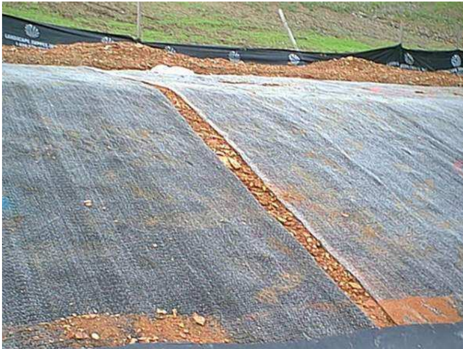
Figure 14 – Photographie illustrant l'écartement entre lés après que la géomembrane ait été retirée (d'après Thiel et Richardson, 2005)
