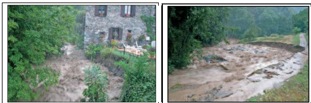
Figure 11 :Maison endommagée (gauche) et d'une route communale détruite (droite)
