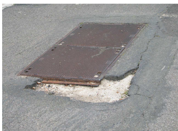
Figure 4 : Illustration de traces d'inondation par ruissellement. Ici dégradation de chaussée, bassin versant de la Mérentaise, Essonne (Photos Y. Nédélec)
