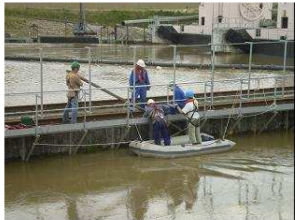
Photo 4 : Mise en place du répulseur à infrasons dans la chambre d'eau de la centrale de Baigts le 22 mai 2008
