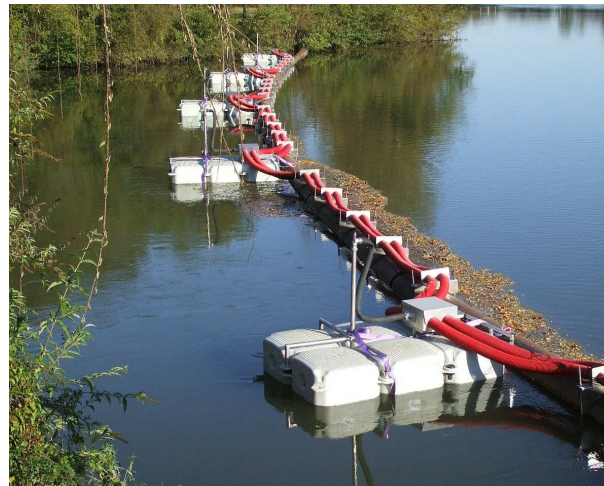
Photo 10 : Barrière à infrasons installée à l'entrée du canal d'amenée de l'usine de Biron. Les 5 répulseurs sont suspendus à des flotteurs fixés à la drome flottante
