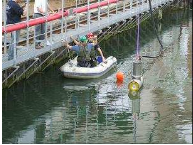
Photo 6 : Accrochage des répulseurs à infrasons à la passerelle de prise d'eau de l'usine de Baigts
