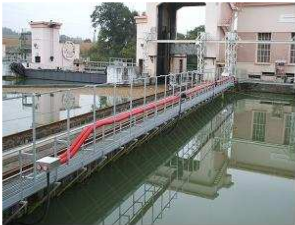
Photo 7 : Vue générale de la passerelle de prise d'eau de la centrale de Baigts après installation des trois répulseurs à infrasons
