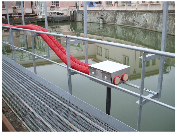
Photo 8 : Détail du boîtier d'alimentation électrique et d'alimentation en air d'un répulseur à infrasons
