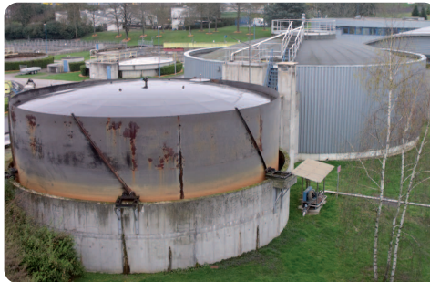
Unité de méthanisation des boues sur la STEU de Limoges ■ Irstea
