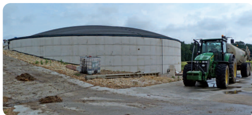
Post digesteur permettant le stockage des digestats après méthanisation ■ Patrick Dabert
