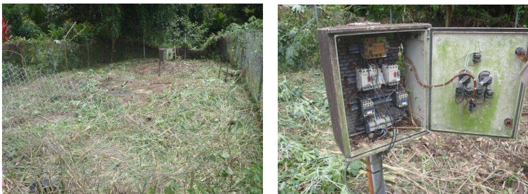
Figure 2 : Cas de STEU à l'abandon (Le Lamentin, Guadeloupe)
