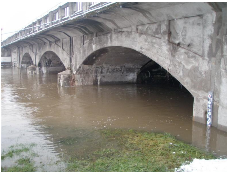
Figure 13 : le pont SNCF depuis la station lors d'une crue à fort débit
