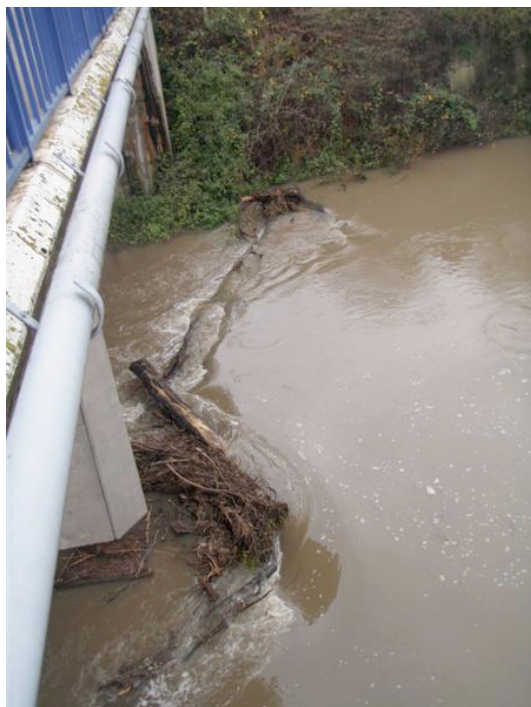
Figure 81 embâcle sur la pile de droite
