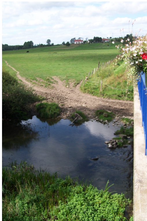
Figure 64: Berge dégradée en rive gauche à l'amont immédiat du pont, où la rivière semble servir d'abreuvoir naturel
