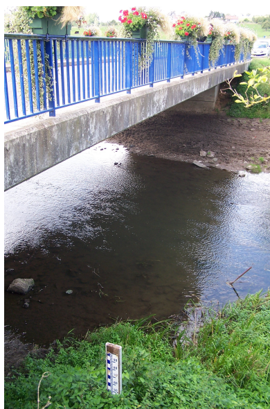
Figure 62: Photo de l'Albe en période d'étiage, sous le pont de la D156F
