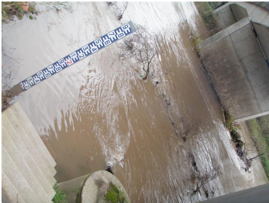
Figure 82 : embâcle sous le pont et contre la pile de droite
