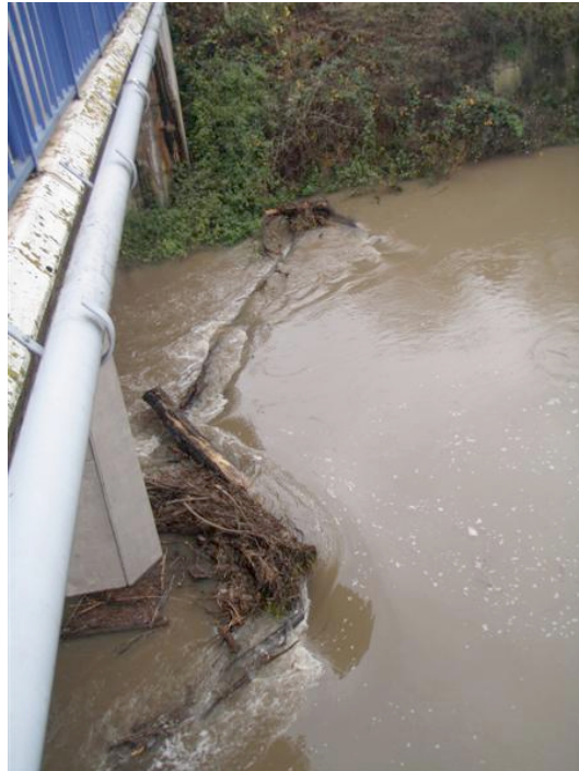
Figure 81 embâcle sur la pile de droite
