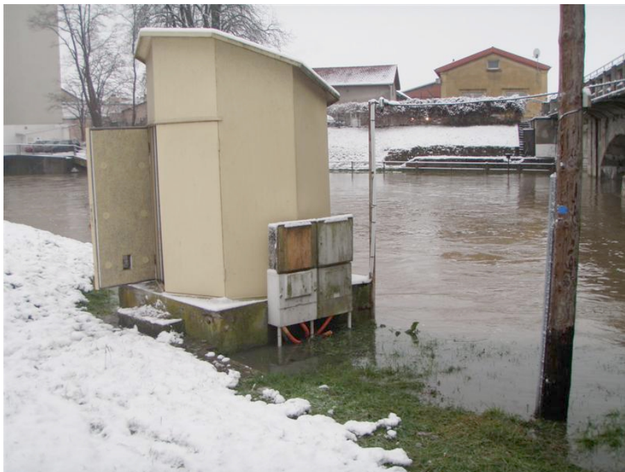
Figure 15 : le local de la station lors d'une crue
