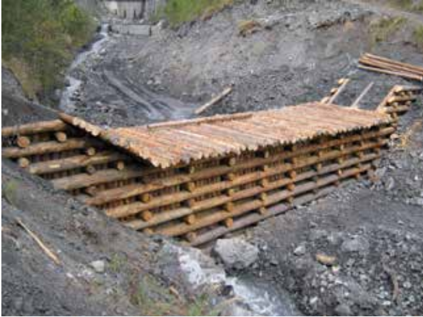
Fig. 25 - Barrage à doubles parois avec parement réalisé avec des bois verticaux.
