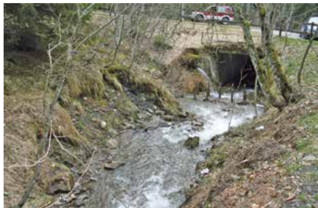
Fig. 15 - Le site lors de l'état des lieux, noter le pont à l'aval.
