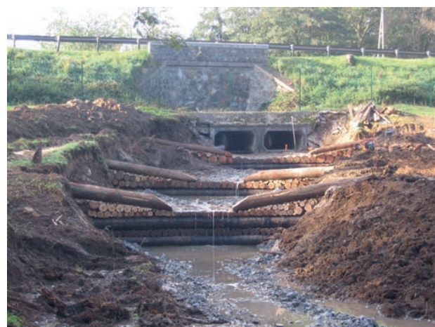
Fig. 24 - Barrage à doubles parois avec parement réalisé en rondins disposés parallèlement aux traverses.
