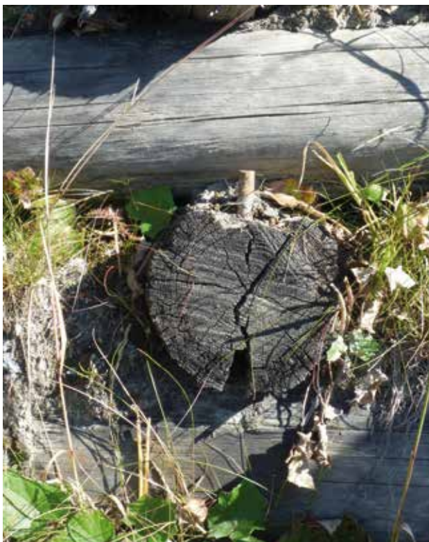
Fig. 41 - Assemblage par broche métallique en cours de dégradation par pourrissement du bois.
