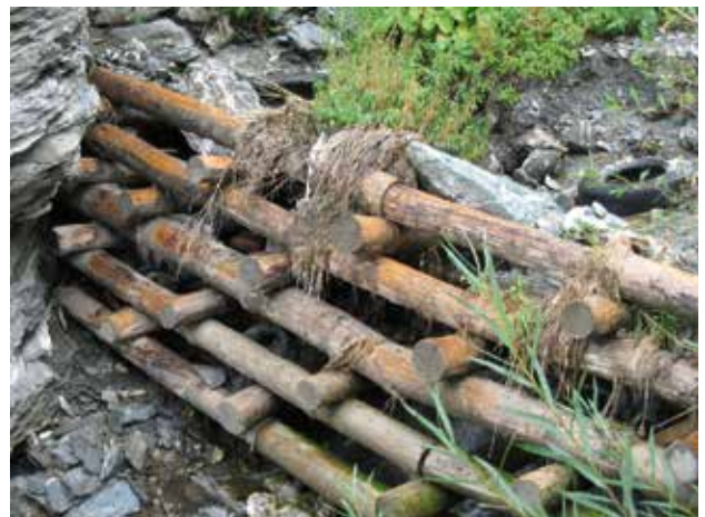
Fig. 35 - Vidange d'un caisson à doubles parois suite à un important affouillement.
