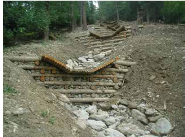
Fig. 22 - Barrage comprenant une cuvette avec parement en pierres à la Norma (Savoie - France).
