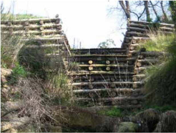
Fig. 26 - Barrage dont les ailes sont réalisées avec des longrines horizontales à Bordighera (Ligurie - Italie).
