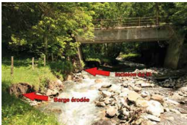
Fig. 4 - Érosion de la berge et incision du lit mettant en danger le pont.
