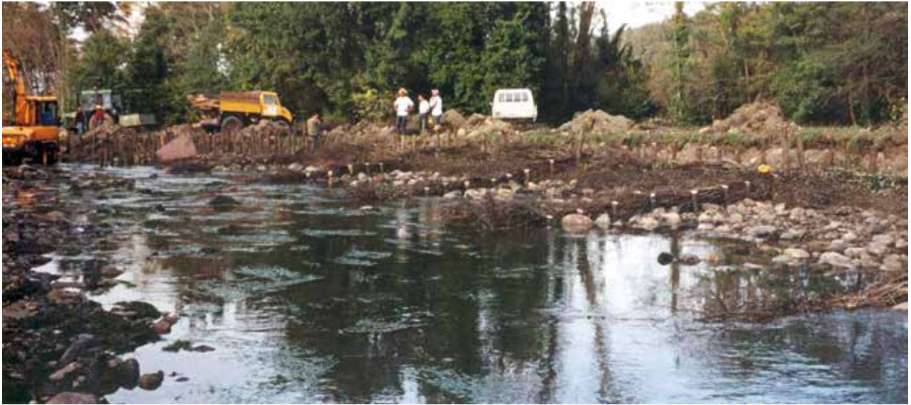
Fig. 63 - Berge de l'Adour pendant les travaux (automne 1999). Remarquez la succession d'épis plongeurs, végétalisés.
