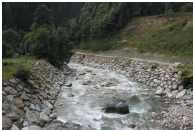
Fig. 5 - Enrochement de berge en rivière de montagne.
