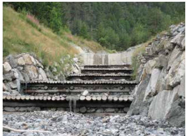
Fig. 34 - Barrage avec platelage en rondins entiers (haute vallée de Suze - Piémont - Italie).
