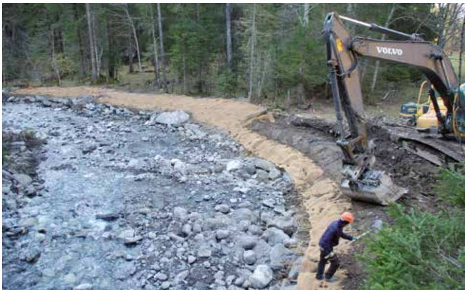
Fig. 28 - Lit de plants et plançons en cours de réalisation. Dans le lit, les deux épis en enrochement sont visibles.
