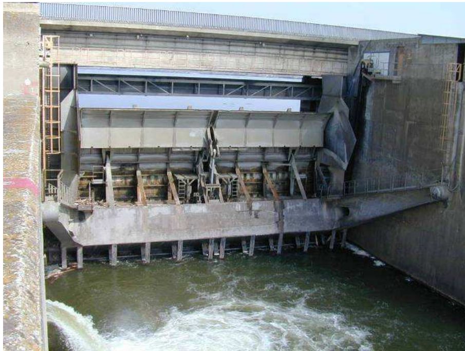
Photo 3.4 – Vanne segment munie d'un volet de surface, barrage de Caderousse
