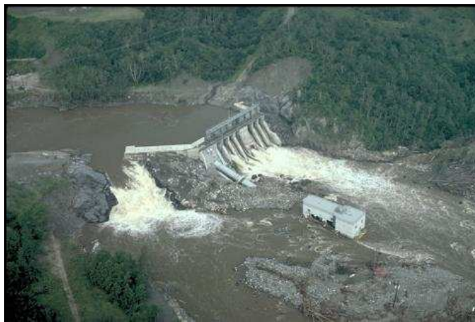
Photo 5.1 – Brèche de 20 m dans le mur en aile du barrage de Jonquière
