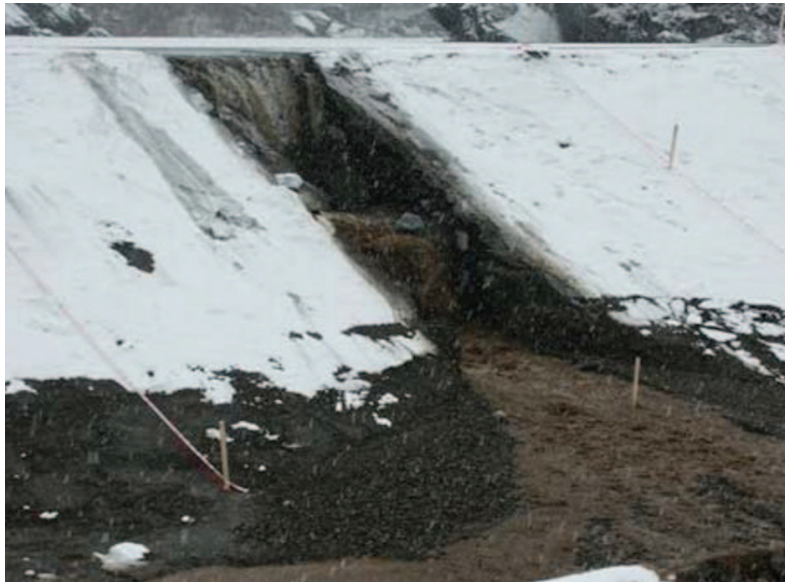
Figure 14. Projet Impact (2002) : phase de headcutting précédant la défaillance du parement côté rivière sur une digue de 5 m de haut
