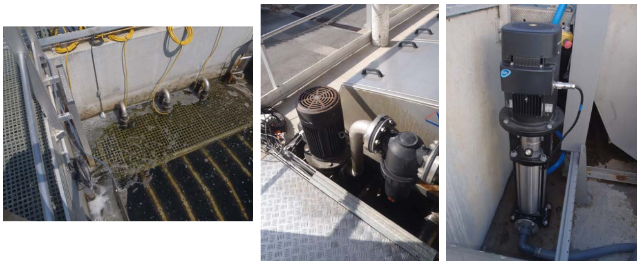
Figure 28. Photos des pompes de lavage des trois filtres étudiés (sites A, B, C)
