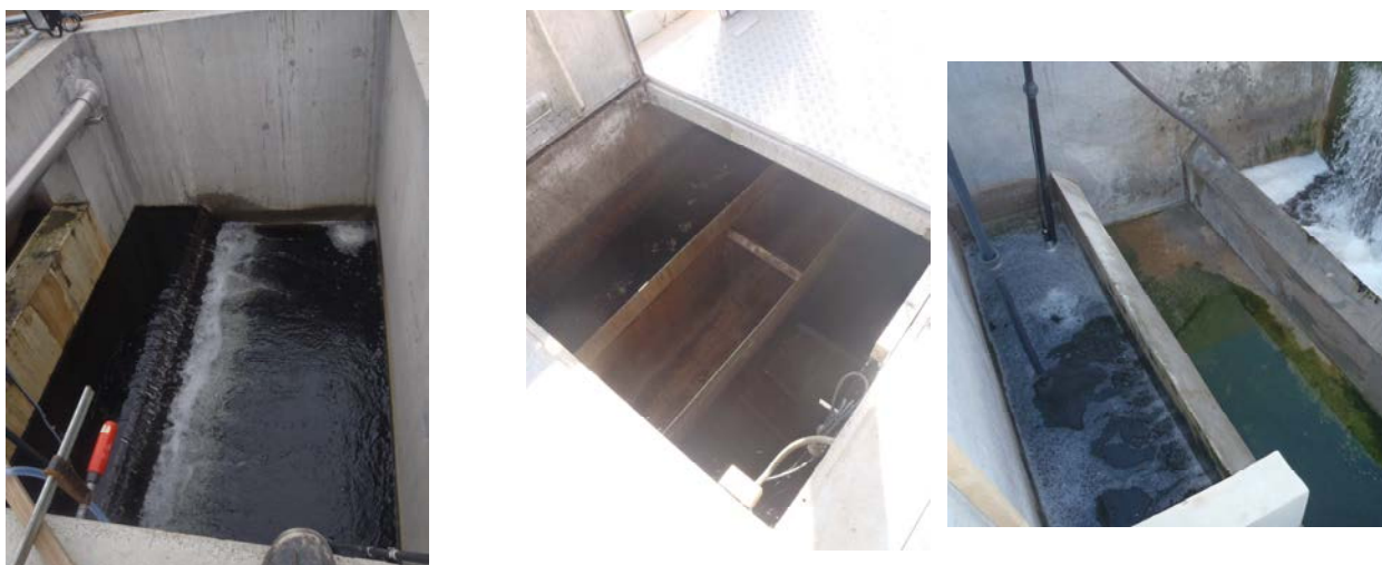
Figure 29. Photos des by-pass amont des trois filtres étudiés (sites A, B, C)
