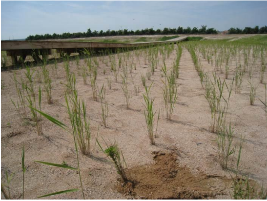
FIGURE 1: FILTRE PLANTÉ POUR LE TRAITEMENT DES EAUX PLUVIALES STRICTES – GARE TGV BEZANNES (51) (PHOTO SINBIO)
