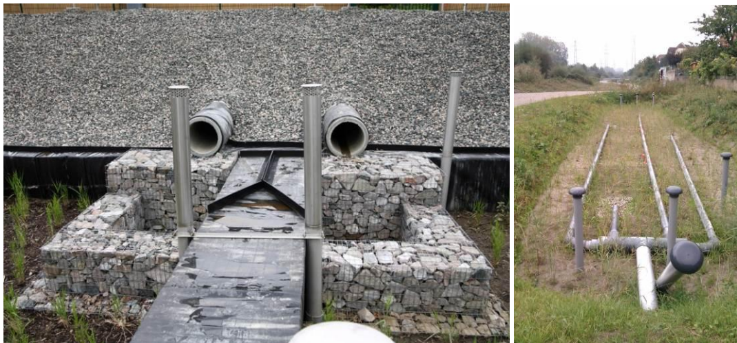
FIGURE 22 : REPRÉSENTATION DE DISPOSITIF D'ALIMENTATION POUR DE GROS DÉBITS AVEC GABION ANTI AFFOUILLEMENT (SITE DE MARCY L'ÉTOILE (69), GAUCHE) ET POUR DE FAIBLES DÉBIT (SITE D'OSTWALDDERGRABEN (67) , DROITE)
