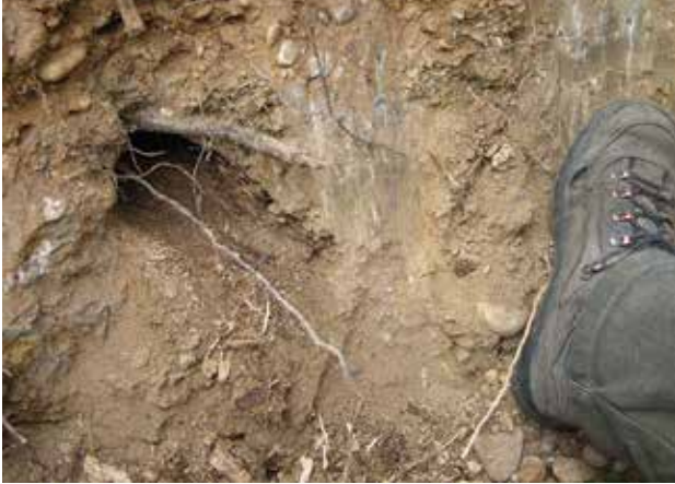
Fig. 7 - Départ de galerie créée par une racine décomposée en pied de digue dans des matériaux cohésifs.
