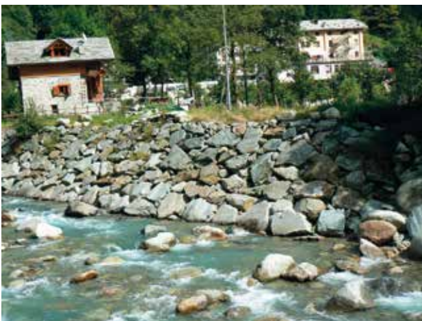
Fig. 20 - Protection de berge en enrochement sur un torrent de montagne.
