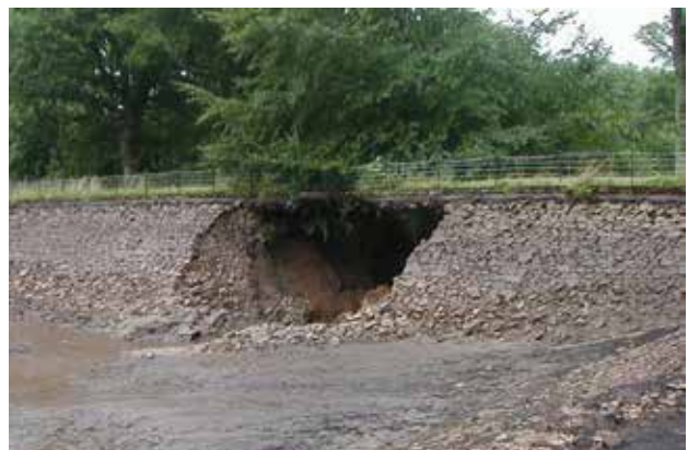
Fig. 6 - Conséquences d'un renard hydraulique sur le barrage des Ouches (Puy-de-Dôme - France).
