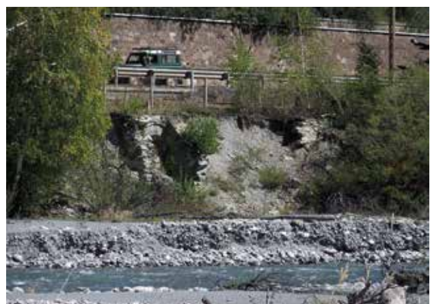
Fig. 3 - Érosion de berge menaçant plusieurs enjeux socio-économiques sur la Dora di Bardonecchia (Piémont - Italie) : route, chemin de fer, réseau électrique.
