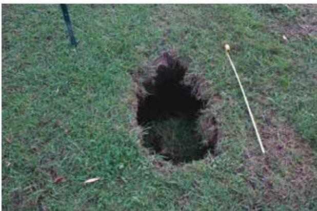
Fig. 5 - Effondrement en crête de digue suite à la décomposition d'une souche.
