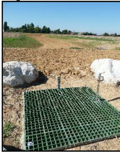
Seuil et vanne dans un regard
