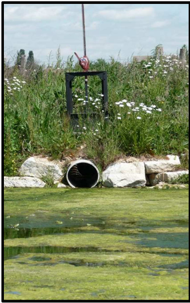
Vanne d'alimentation du bassin
