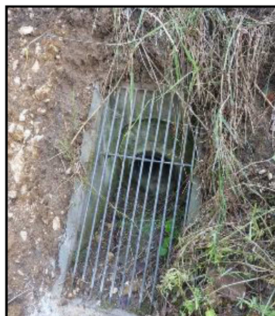
Exutoire d'un collecteur de drainage
