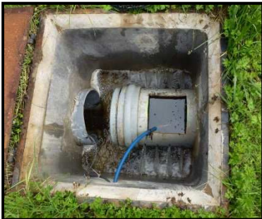
Ouvrage de vidange
