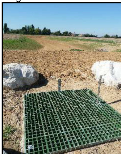
Seuil et vanne dans un regard
