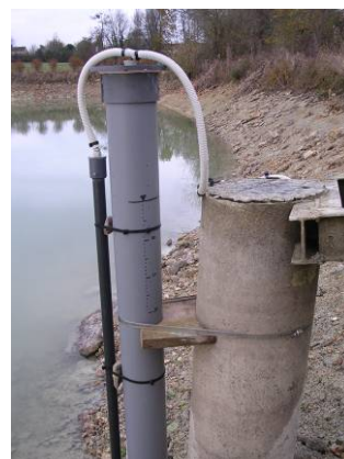
Figure 6 : Surverse du bassin.
