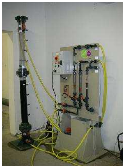
Figure 2 : Colonne de charbon actif avec sa panoplie sur le site A w
