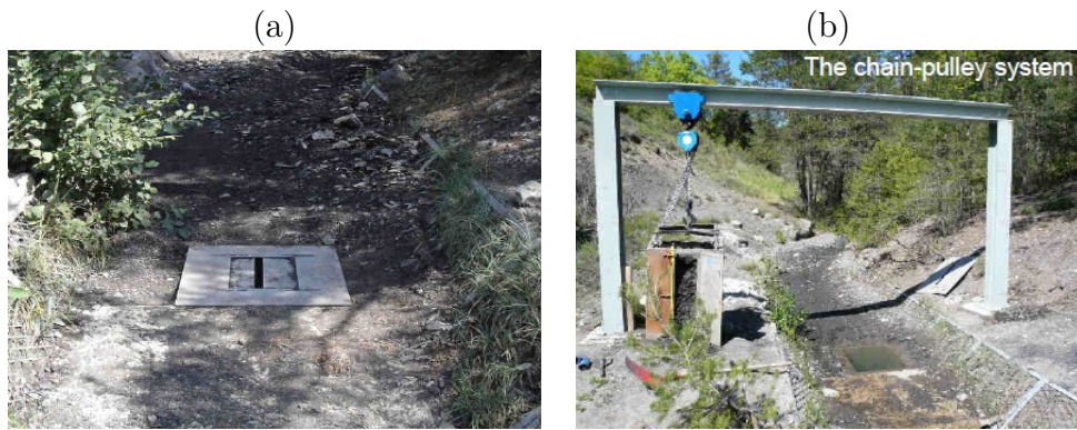
FIGURE 2.7 – Trappe à sédiment sur le torrent du Moulin (Photos F. Liébault).
