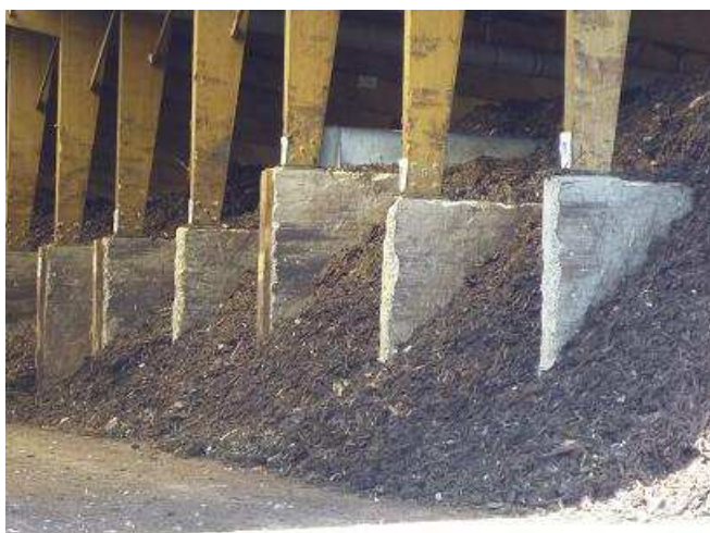
Figure 24 : Casiers de fermentation du site Fs (compostage casier)
