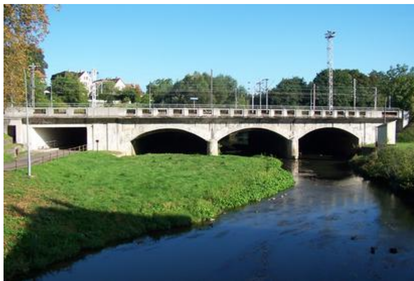
Figure 21 : Vue, à bas débit et depuis l'amont, de la station de la Sarre à Sarrebourg (code Hydro A9021010) avec au fond le pont SNCF situé en aval et au premier plan le remblai submersible situé en rive gauche
