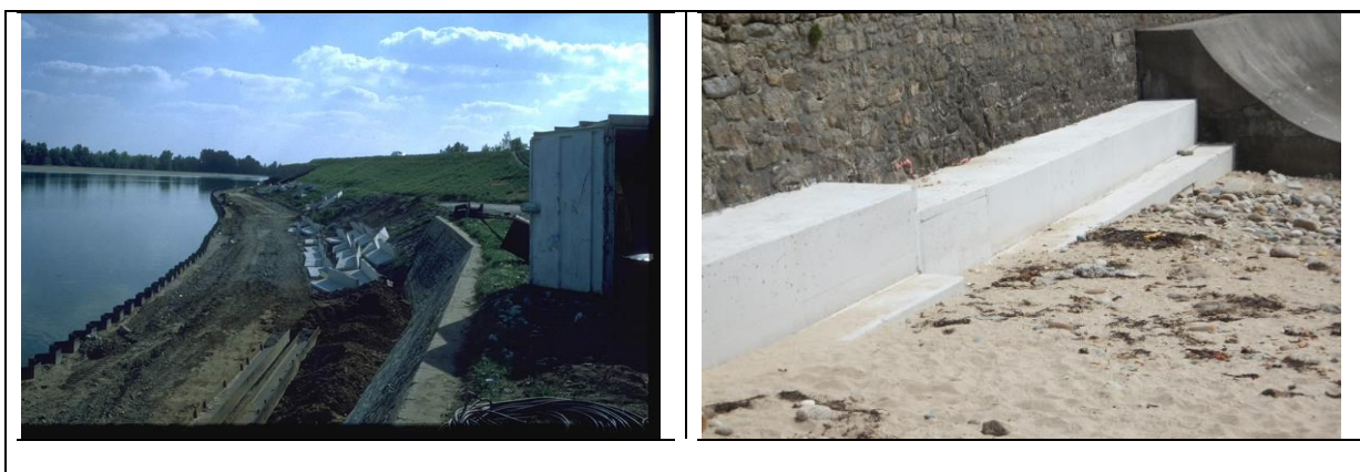
Figure 4.9 : exemple de confortement par palplanches pour lutter contre les affouillements en pied de talus – Source Cerema
