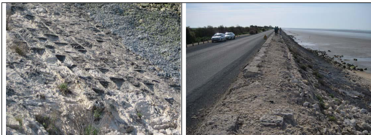
Figure 2.22 – Digue du Génie : Abrasion des pierres coté mer (les joints ciment restent en saillie) et effritement de la crête - Source Irstea.
