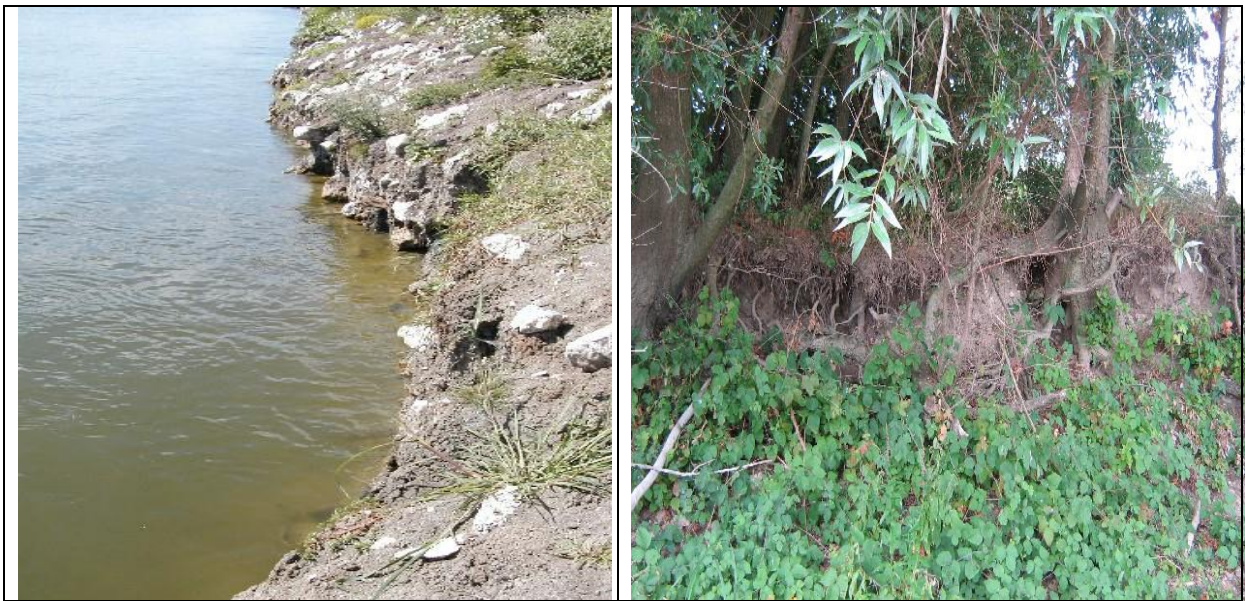
Figure 2.20 – a – Erosion d'une digue non protégée pourtant constituée de matériau contenant des éléments pierreux ; b – L'érosion du talus est ici ralentie par les racines d'arbres mais ces derniers sont ainsi fragilisés en cas de chute par le vent le départ de la souche constituera une « encoche » dangereuse pour la digue
