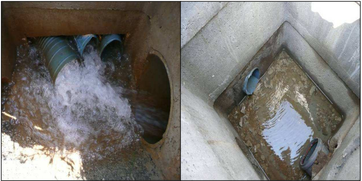
Figures 11a et 11b : Regards d'alimentation et de rejet de « PRAIRIE 4 ». Source Irstea
