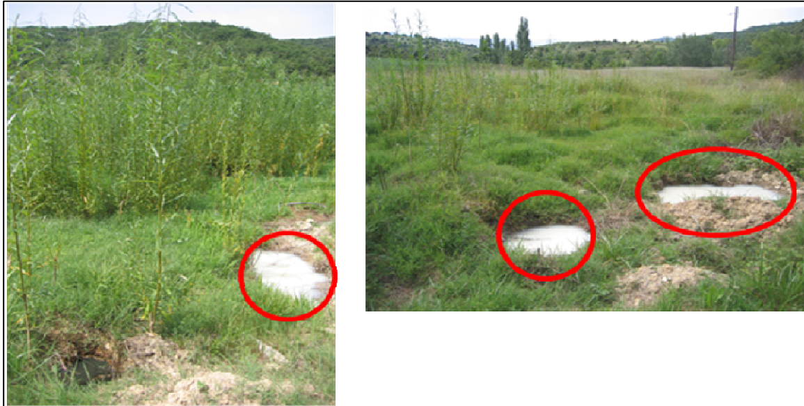
Figures 14a et 14b : Fuites du système d'alimentation du TTCR. Source Irstea
