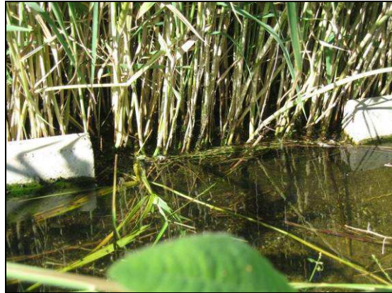
Figure 2 : Obstruction des déversoirs par les roseaux plantés. Source ARPE.
