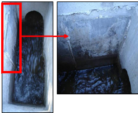
Figure 19 : Obstruction du by-pass de « BASSIN 1 ». Source ARPE
