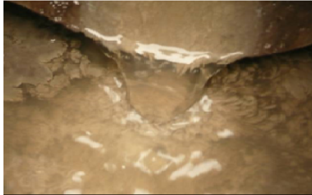
Figure 67 : Rejet de filaments blanchâtres de la station alimentant « AUTRE 3 ». Source Irstea
