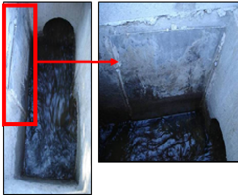
Figure 19 : Obstruction du by-pass de « BASSIN 1 ». Source ARPE
