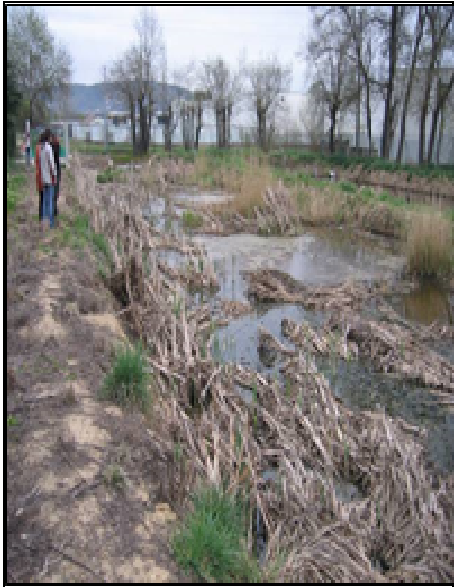
ZRV s'apparentant à un bassin filtrant « AUTRE 4 » : accumulation de débris, absence d'entretien et colmatage
