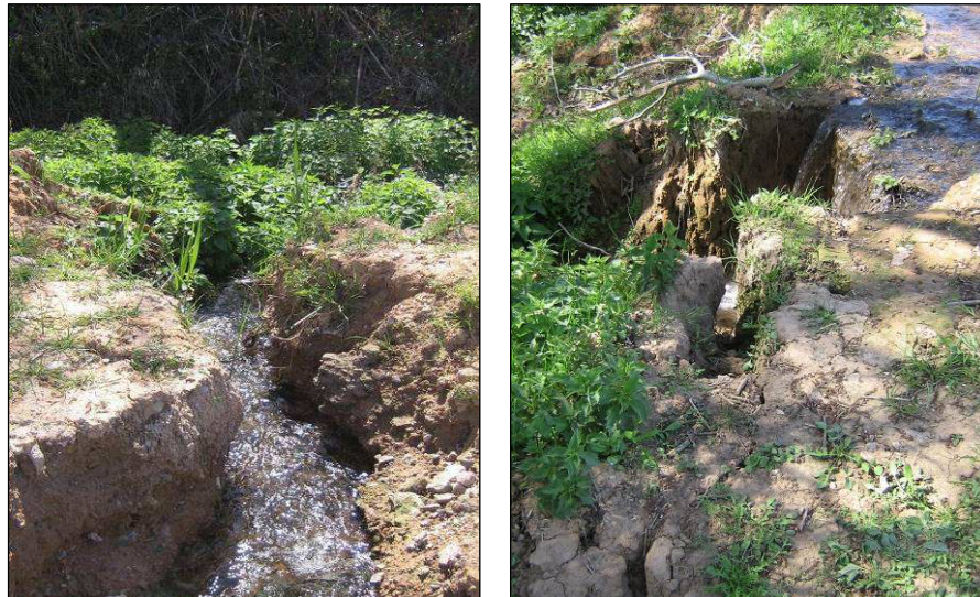
Figures 3a et 3b : Ravinement des berges. Source ARPE.
