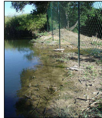
Figure 20 : Déversement localisé en un point unique au lieu de trois. Source ARPE
