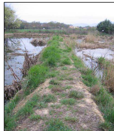
Figure 72 : Talus central étroit. Source Irstea
