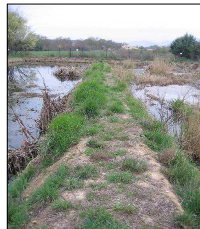
Figure 72 : Talus central étroit. Source Irstea
