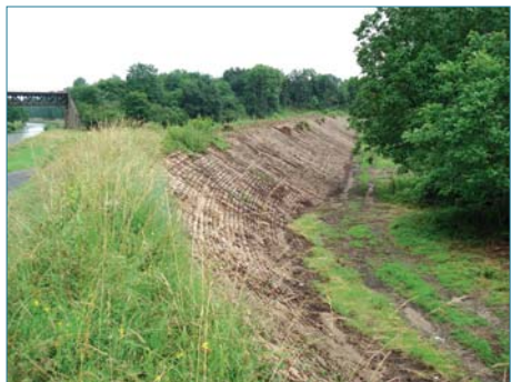
Figure 3.5. Digue de la Loire avec perré maçonné. Noter les rejets de souche d'arbres poussant directement dans le perré et récemment coupés (ph. C. Zanetti).
