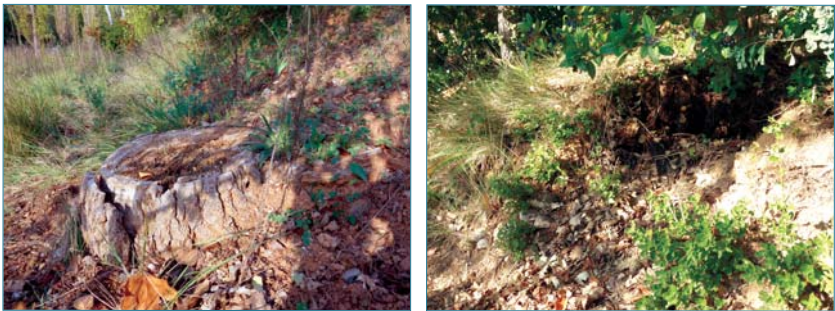
Figure 4.9. Souches pourrissantes au pied d'un talus de digue. (a) Dans une première étape, la souche est encore visible. (b) Dans une deuxième étape, la souche pourrissante provoque un petit effondrement local et un début d'érosion. Des tourbillons en cas de crue peuvent surcreuser cette encoche dans le talus (digue de protection, talus côté cours d'eau). Dans une troisième étape, il ne restera peut-être qu'une irrégularité dans la surface du talus, mais si la souche était grosse et profonde, cette zone sera durablement fragilisée. Elle pourra donner lieu à un fontis (fig. 4.8), favoriser une érosion importante du talus lors d'une crue, ou faciliter une érosion interne (photos M. Venetier).
