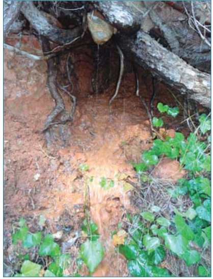
Figure 1.10. Érosion interne active débouchant sous une vieille souche en décomposition, l'eau suivant probablement le cheminement de racines dans le talus. (ph. M. Vennetier).
