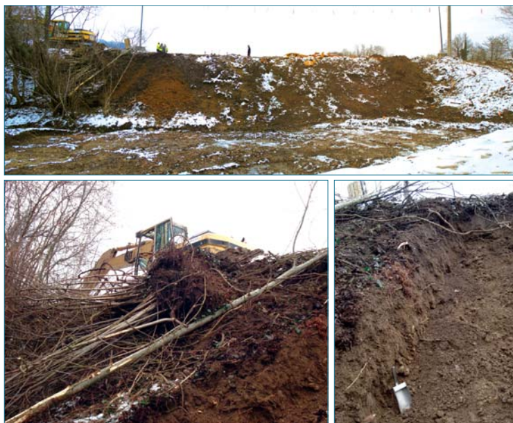
Figure 5.28. Déracinements d'arbres sur le parement aval et appréciation du développement racinaire dans les fouilles du futur évacuateur de crues (février 2010) (photos Cemagref/Irstea).
