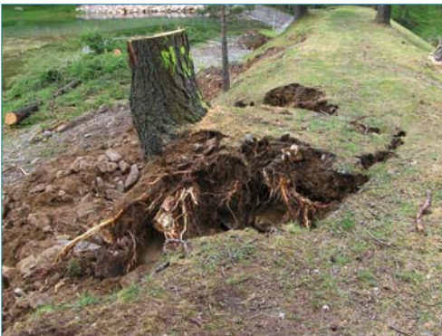
Figure 1.19. Système racinaire d'un mélèze ayant déstabilisé une digue sur plus de la moitié de sa largeur. Certaines grosses racines s'enfoncent profondément au cœur de l'ouvrage (ph. Zanetti C.).
