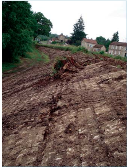
Figure 1.7. Colonisation par des racines d'arbres d'un joint ouvert de perré maçonné. Amorces de déstructuration pouvant aboutir à un large trou dans l'ouvrage en cas de déracinement de l'arbre (ph. C. Zanetti).
