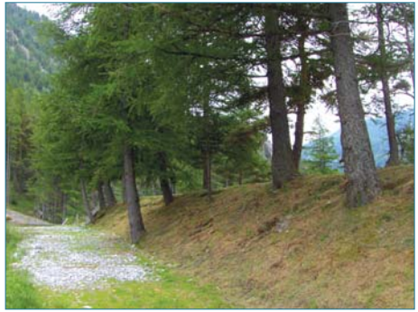
Figure 3.19. Couvert arboré moyen à dense dominant une pelouse sur digue étroite. L'élimination des arbres, dont le système racinaire occupe tout le remblai avec de grosses racines traversantes, implique à terme la rénovation complète de l'ouvrage (ph. C. Zanetti).
