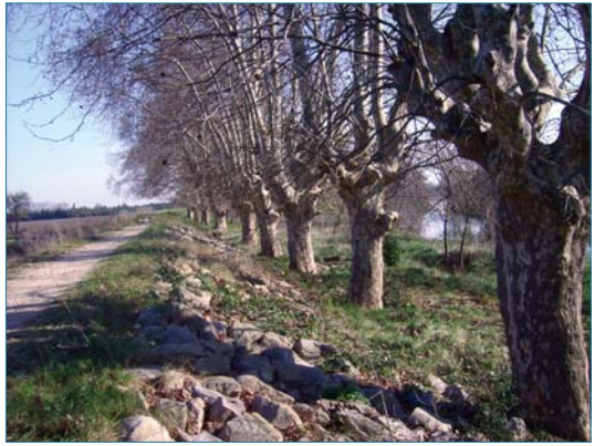
Figure 5.3. Gros platanes en alignement sur le ségonnal d'une digue du Vidourle. Les racines de ces arbres peuvent traverser de part en part les soubassements de la digue, comme illustré par la figure 1.16 (p. 39). Leur déracinement lors d'une crue ou d'une tempête, bien qu'assez peu probable, déstabiliserait le pied du talus (ph. M. Vennetier).
