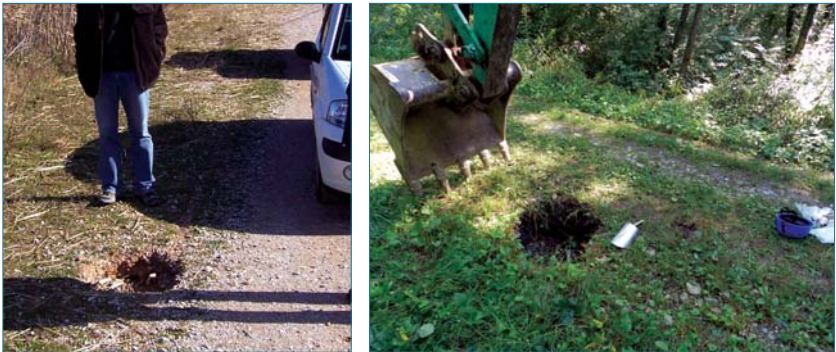
Figures 4.8. Fontis d'origines différentes sur une crête de digue résultant : (a) d'écoulements internes lors d'une crue récente (photo prise lors d'un examen visuel post-crue), (b) de la probable décomposition d'une grosse souche pour cette digue située en environnement boisé (photos P. Mériaux).
