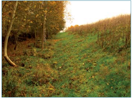
Figure 4.5. Haie d'arbres trop proche du pied de parement aval d'un barrage, avec troncs poussant au débouché du tapis drainant (ph. P. Mériaux).
