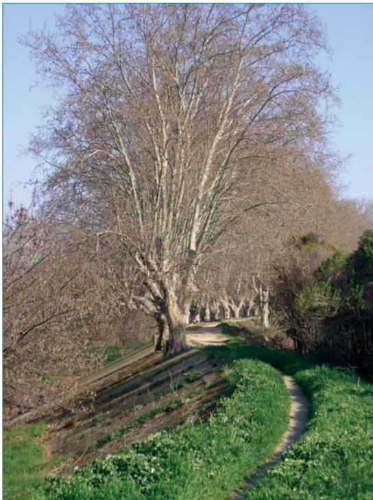
Figure 1.20. Alignement de platanes centenaires sur une crête de digues à charge temporaire. Un perré bétonné protège le talus côté fleuve mais il est par endroits soulevé par les racines. Le système racinaire de ces platanes occupe la totalité du corps de digue. Leur déracinement provoquerait une loupe d'arrachement au moins équivalente, en proportion, à celle de la figure 1.19 (ph. M. Venetier).
