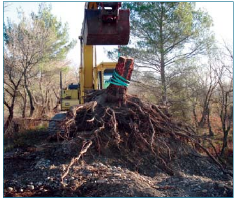
Figure 4.22. Arrachage d'un arbre avec une grande partie de son système racinaire qui a été préalablement dégagé (ph. C. Zanetti).
