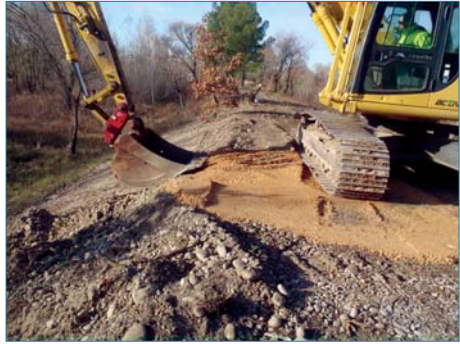
Figure 4.23. Réfection du talus et de la crête de digue, après élimination des arbres dangereux : régularisation de la pente, apport local et tassage de matériaux (ph. C. Zanetti).
