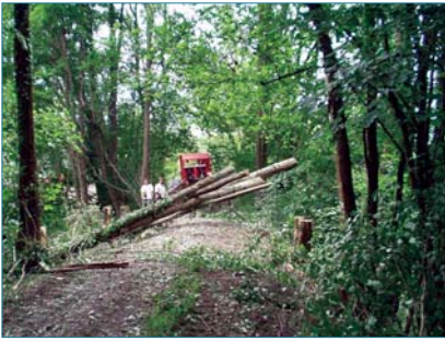
Figure 5.13. Exploitation des arbres dans un secteur fortement boisé. Dans les zones critiques pour la sécurité, les souches des plus gros arbres ont été arrachées et le remblai reconstitué (ph. C. Ripert).
