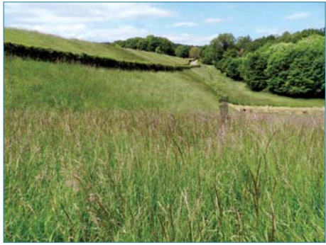
Figure 4.3. L'absence de fauche récente rend difficile l'examen visuel du parement aval enherbé de ce barrage (ph. P. Mériaux).
