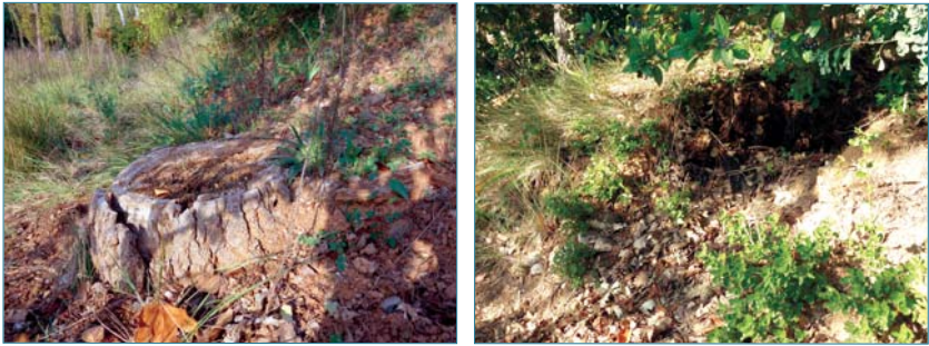
Figure 4.9. Souches pourrissantes au pied d'un talus de digue. (a) Dans une première étape, la souche est encore visible. (b) Dans une deuxième étape, la souche pourrissante provoque un petit effondrement local et un début d'érosion. Des tourbillons en cas de crue peuvent surcreuser cette encoche dans le talus (digue de protection, talus côté cours d'eau). Dans une troisième étape, il ne restera peut-être qu'une irrégularité dans la surface du talus, mais si la souche était grosse et profonde, cette zone sera durablement fragilisée. Elle pourra donner lieu à un fontis (fig. 4.8), favoriser une érosion importante du talus lors d'une crue, ou faciliter une érosion interne (photos M. Venetier).
