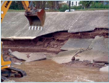
Figure 4.32. Mise en évidence de racines traçantes en sous-face de perré sur la digue du Reyran, suite à la crue de novembre 2011 (ph. G. Degoutte, Irstea/CGAER).
