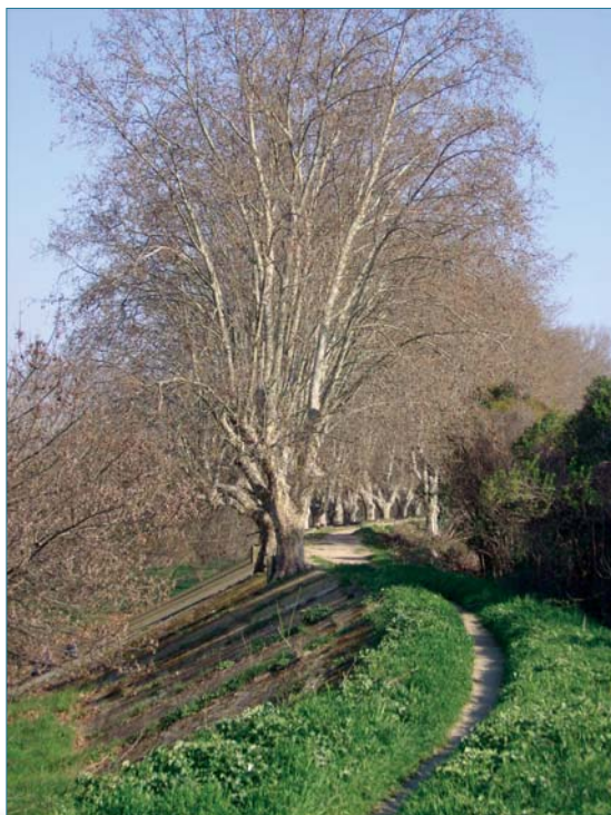
Figure 1.20. Alignement de platanes centenaires sur une crête de digues à charge temporaire. Un perré bétonné protège le talus côté fleuve mais il est par endroits soulevé par les racines. Le système racinaire de ces platanes occupe la totalité du corps de digue. Leur déracinement provoquerait une loupe d'arrachement au moins équivalente, en proportion, à celle de la figure 1.19 (ph. M. Venetier).
