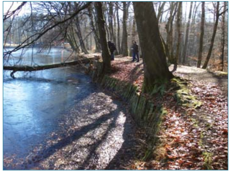
Figure 4.10. Arbres de haute tige, au port dangereusement penché, se développant au-dessus du niveau normal des eaux d'un petit barrage d'étang et ayant tendance à déstructurer la protection anti-batillage, ici par pieux-bois (ph. P. Mériaux).
