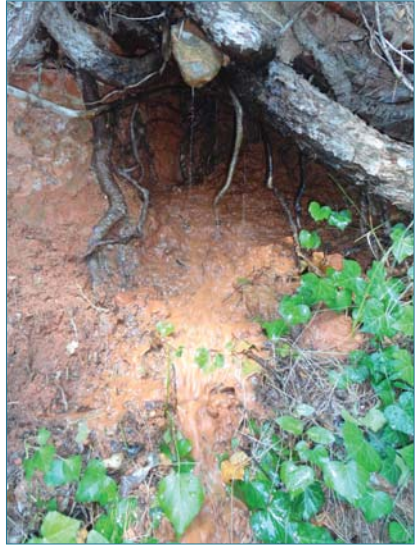
Figure 1.10. Érosion interne active débouchant sous une vieille souche en décomposition, l'eau suivant probablement le cheminement de racines dans le talus. (ph. M. Vennetier).
