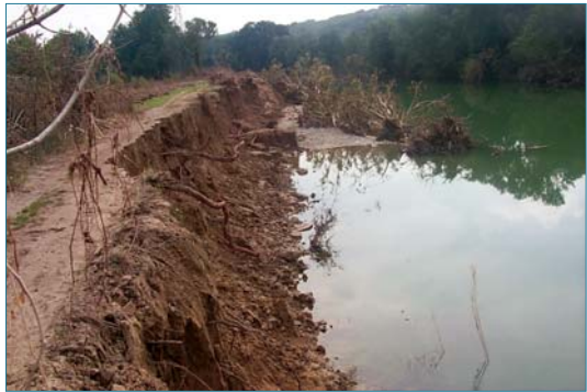
Figure 5.2. Glissement d'une berge très raide sur le Vidourle. On note dans l'eau la présence de certains des arbres qui occupaient le talus, et les très grosses racines traversantes d'arbres disparus, emportés par le courant ou maintenant immergés (ph. G. Degoutte).
