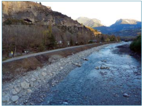
Figure 5.10. État immédiatement après travaux (lot aval). Les arbres du parement côté zone protégée de la digue sont conservés. À comparer avec la figure 5.8 (ph. P. Mériaux).
