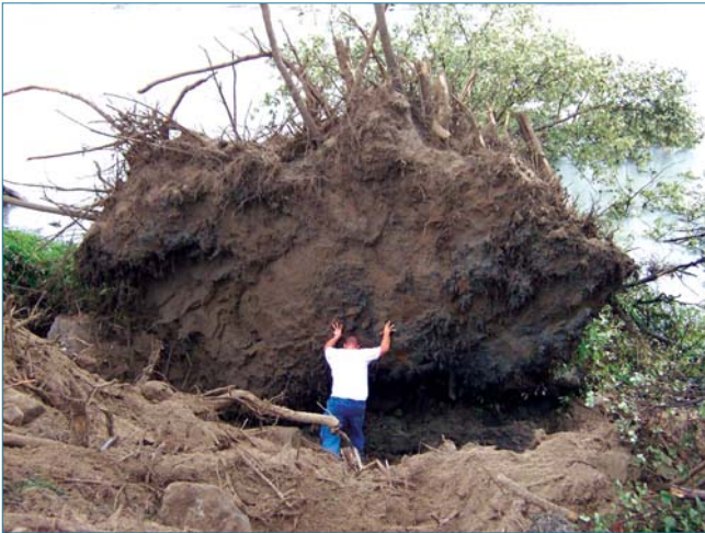
Figure 3.26. Peuplier déraciné sur une digue de protection contre les inondations en Californie, emportant une imposante masse de terre. Cette encoche pourra générer des tourbillons érosifs en cas de crue. Le déracinement a aussi totalement déstructuré les matériaux en surface du talus sur plusieurs dizaines de mètres carrés au-delà de la motte arrachée (au premier plan), et éparpillé les blocs d'un enrochement de surface à travers lequel il avait poussé. Le talus est donc, jusqu'à sa réfection, très vulnérable à l'érosion (ph. C. Iffr, USACE).
