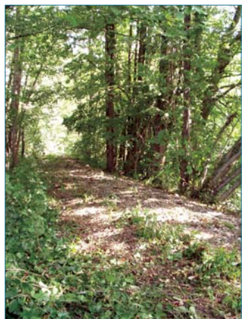
Figure 5.11. L'abandon de l'entretien courant des digues après 1970 avait conduit au développement d'une forêt luxuriante sur une grande partie des talus (ph. C. Ripert).
