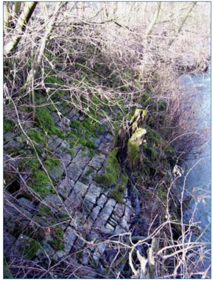
Figure 4.37. Perré non jointoyé en cours de destruction par l'action des arbres et de leurs racines, au bord de la Sarre (ph. P. Mériaux).
