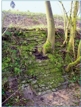
Figure 4.11. Arbres commençant à détruire un ouvrage de protection de berge en maçonnerie de pierres (ph. P. Mériaux).
