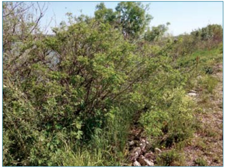
Figure 3.18. Couvert arbustif dense gênant l'inspection visuelle. Le retour à une situation satisfaisante (type 2) peut être rapide et n'impose pas de travaux de réfection du remblai (ph. M. Venetier).
