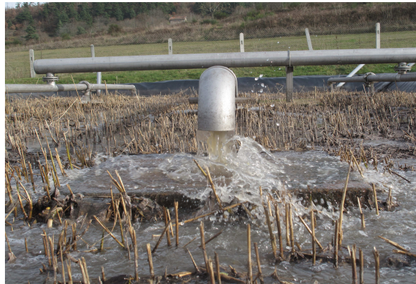
Point de distribution et système anti-affouillement
