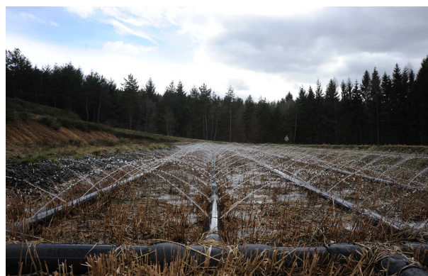
Distribution par aspersion
