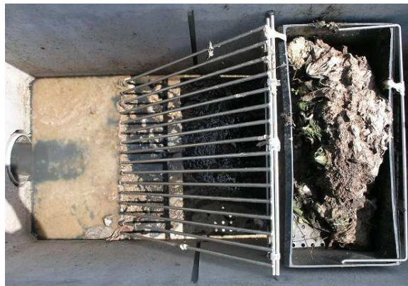
Dégrillage manuel par grille oblique en acier inoxydable
