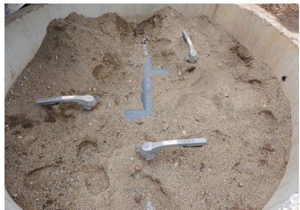
Dispositif de sélection des filtres par vannes
