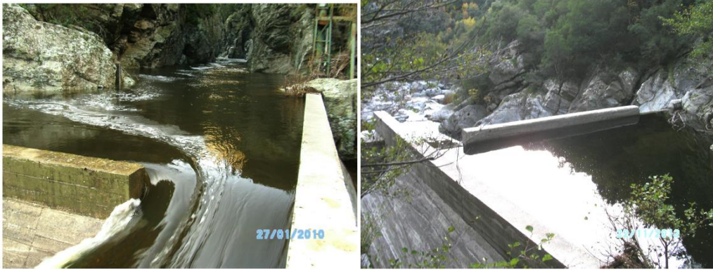
Figure 51 - Le Bevincu à Lancone (Haute-Corse). Vue des déversoirs vers l'amont (photo de gauche) et vers l'aval (photo de droite)
