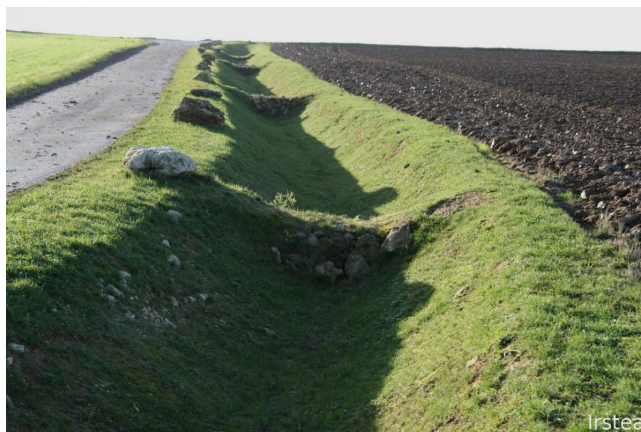
Fossé à redents (Photo : Irstea)
