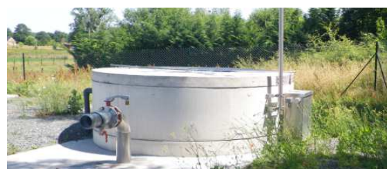
Décanteur-digesteur avec prise de boues pour vidangeur
