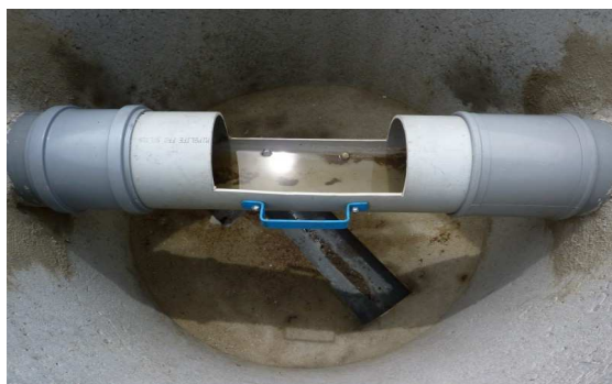
Déversoir d'orage réglable à seuil latéral
